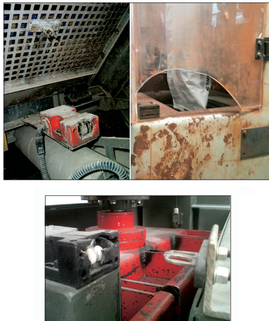
Figura 10: rottura accidentale: interblocco a chiave danneggiato a causa di ripetuti urti per disallineamento dell'attuatore con il sistema di azionamento
