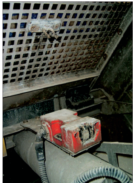
Figura 7: Interblocco esposto a condizioni ambientali severe
