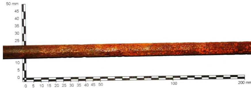
Figura 51 – Esempio di corrosione generalizzata
