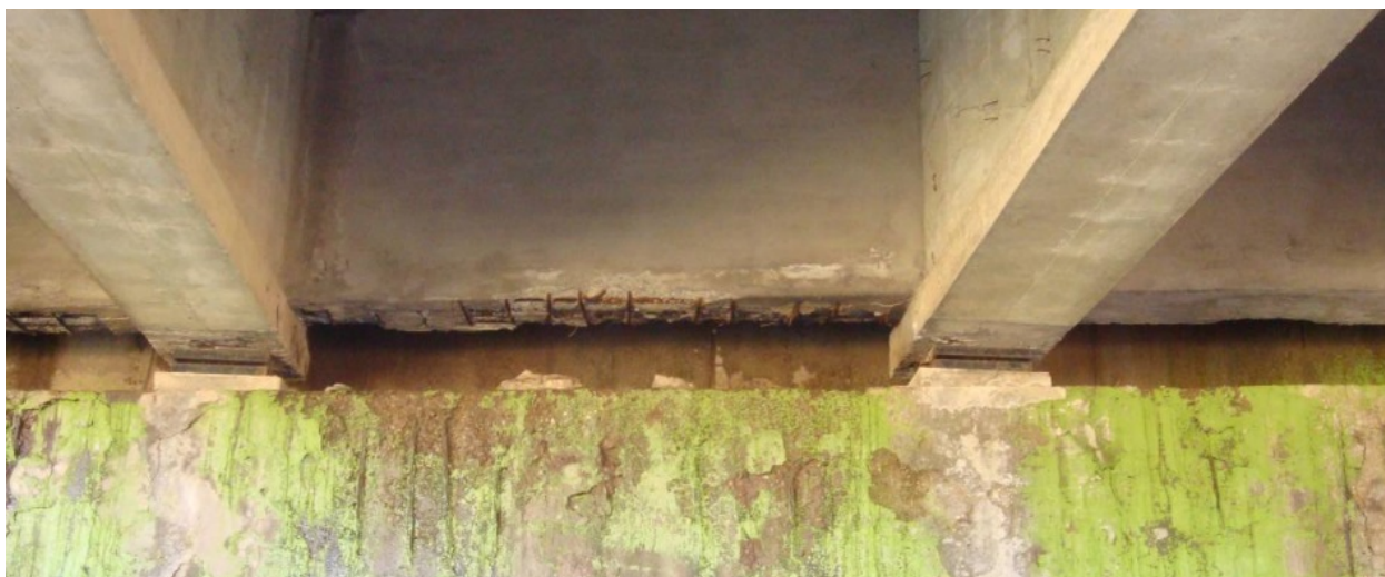
Figura 84 - Degrado intradosso traversi
