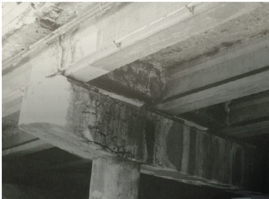
Figura 104 - Degrado del pulvino a causa delle infiltrazioni
