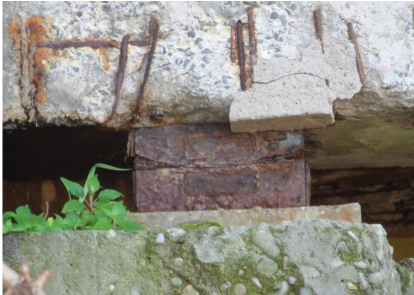
Figura 72 – Corrosione generalizzata del vincolo a cerniera in acciaio.
