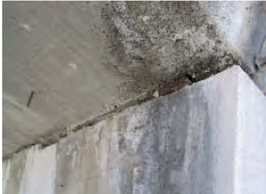
Figura 105 - Degrado giunto su pila ed appoggio
