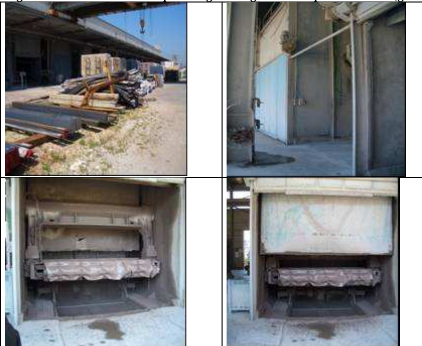
Fig.5-6-7-8: Batteria di telai per il taglio dei graniti incapsulati in box (grande azienda - Toscana)
