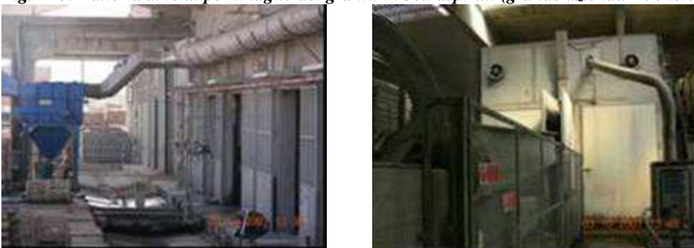
Fig.9-10: Batteria di telai per il taglio dei graniti in box aspirati (grande azienda - Veneto)
