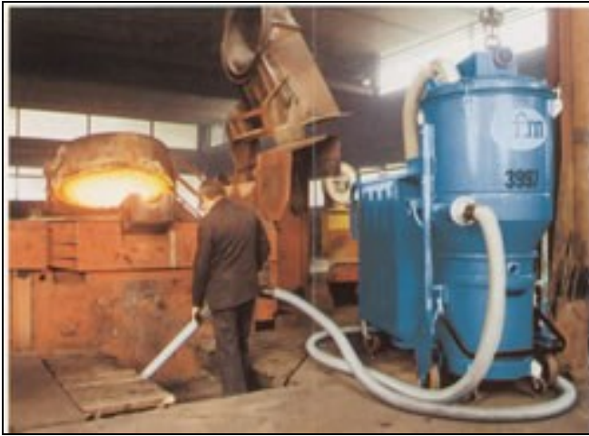
Fig. 2 Impianto aspirapolvere carrellato
