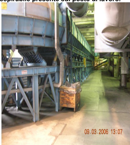
fig. 1 tunnel di sterratura/trasporto dei getti dopo distaffatura.
