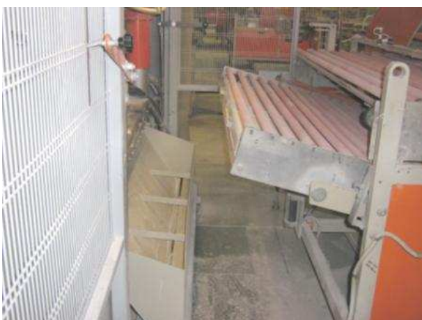
La rulliera mobile all'uscita della pressa, facilita l'accesso per manutenzioni o pulizie.
