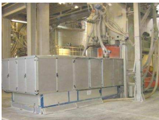
Segregazione della pressa dal lato del caricamento.
