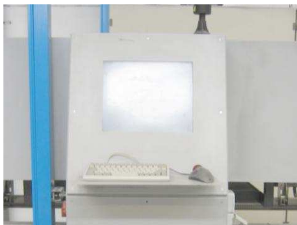
Computer comando-controllo operazioni cabina.
