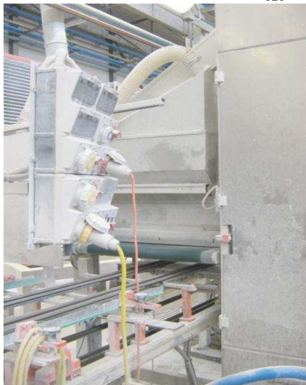
Sopra e a sx.: Applicatore per polveri e graniglie. Visibili l'entrata, l'uscita e il corredo di tubi per l'aspirazione.
