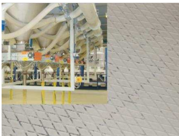
Pavimento di stazione preparazione polveri pulito a secco (in alto a sx. le attrezzature al piano).
