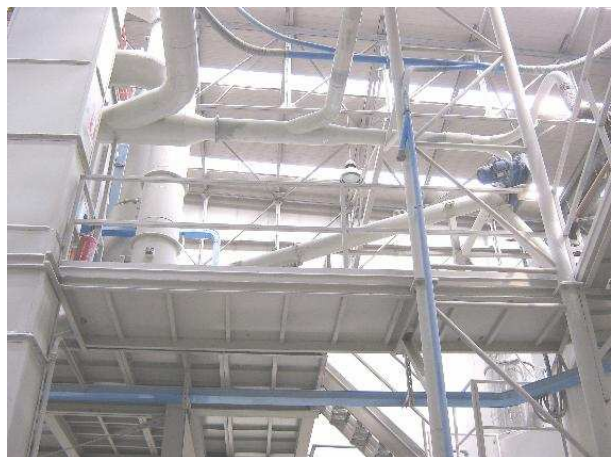
Sopra: Elevatore per il rifornimento delle tramogge.
