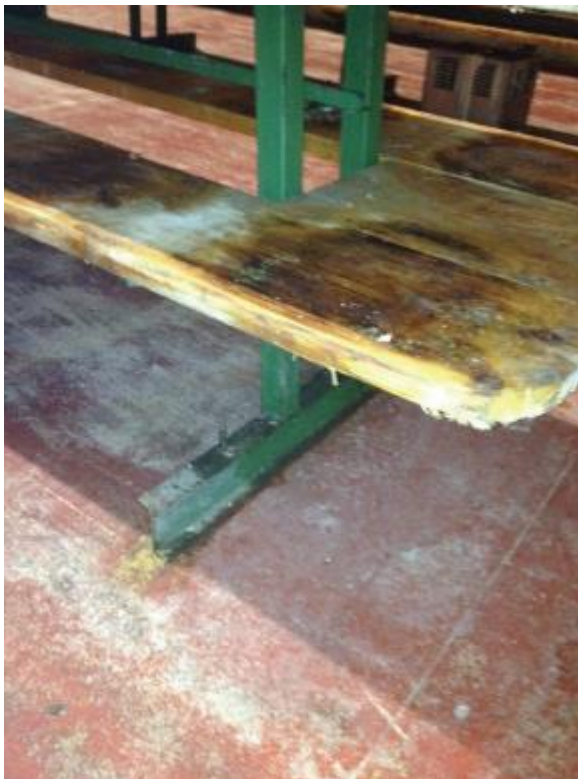
L'assenza del collegamento alla pavimentazione
