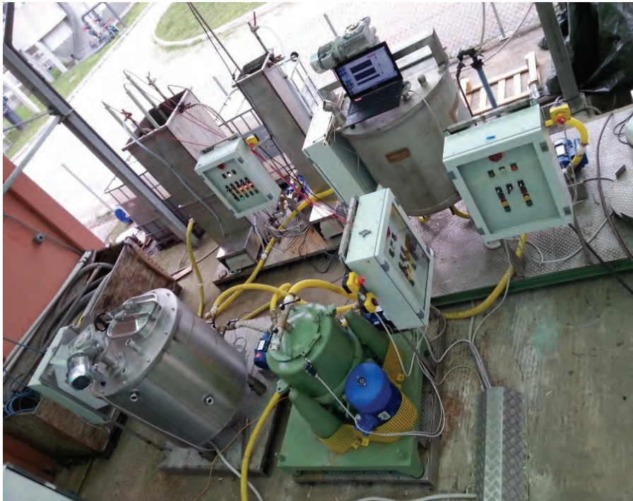
Figura 20 - Unità di processo installate ed operative per la produzione di PHA (dalla coltivazione della biomassa alla fase finale estrattiva del prodotto)
