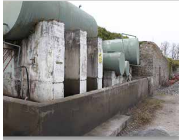
Usate strutture sigillate per lo stoccaggio dei combustibili.
