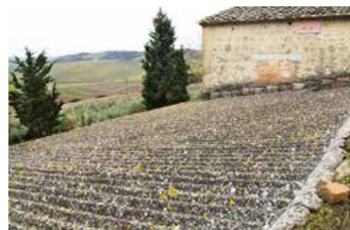
Un tetto in buone condizioni può restare così com'è.
