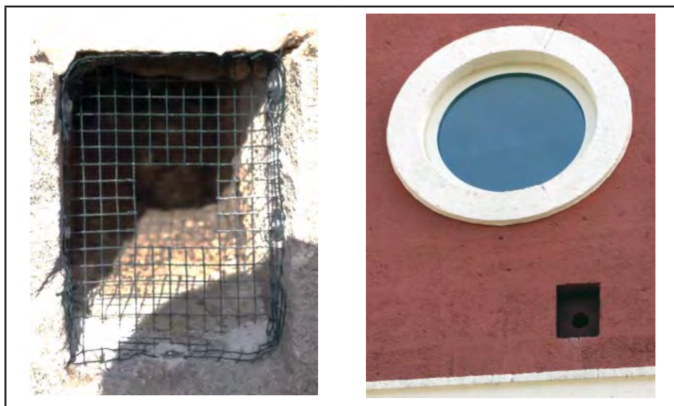
Figura 14. Due esempi di interventi realizzati a Gravina in Puglia nell'ambito del progetto LIFE "Un falco per amico" al fine di favorire la nidificazione del grillaio nelle cavità dei muri esterni di edifici, precludendone l'accesso con rete metallica o muratura a piccioni e taccole, principali competitori per tale risorsa (Foto di Giuseppe La Gioia).
