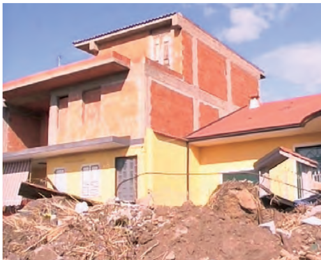
Cumuli di detriti dell'attività edilizia prima della loro rimozione.
