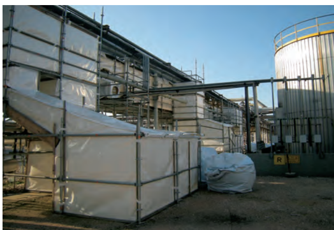
Particolare di area confinata: linee-rack di produzione
