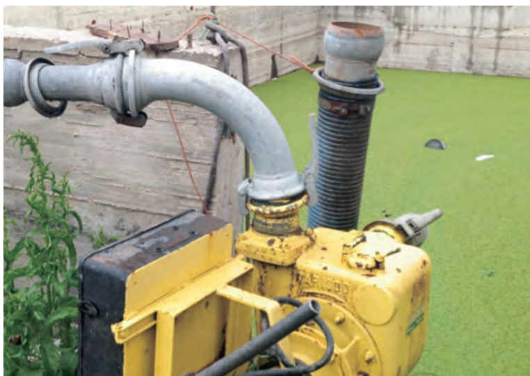
Pompa per la gestione delle deiezioni. Acerra, azienda Errichiello
