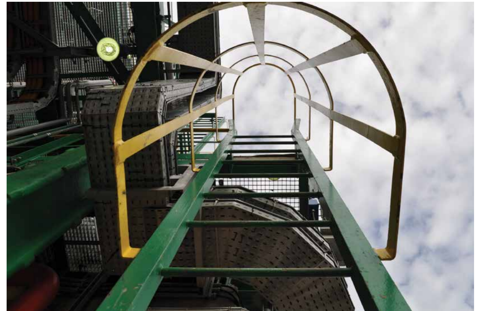
Impianto Val d'Agri: scala di accesso al punto di campionamento (Foto DGS-UNMIG)
