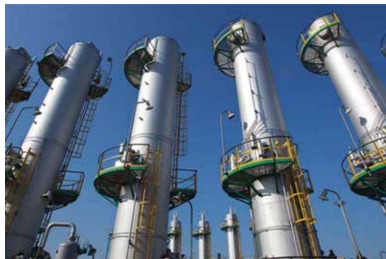
Impianto di disidratazione del gas concessione San Potito - Cotignola Stoccaggio (Foto DGS-UNMIG)
