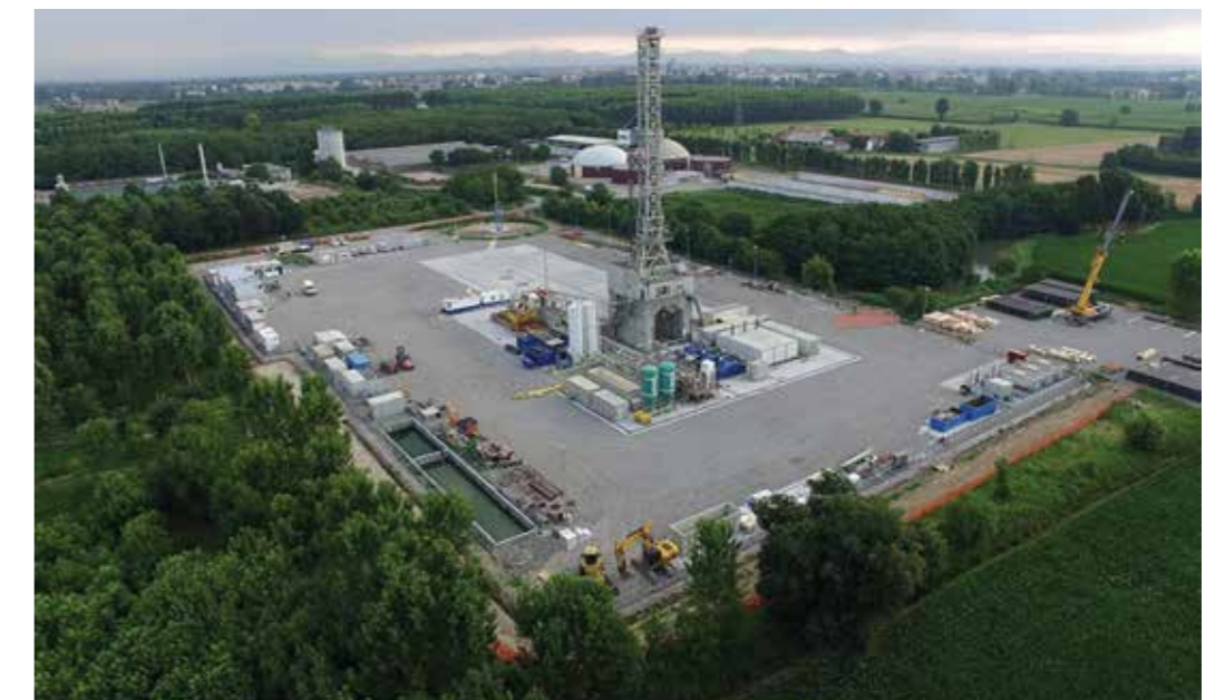
Impianto di stoccaggio di gas naturale di Cornegliano Laudense - cluster b, concessione di stoccaggio "Cornegliano Stoccaggio", operatore Ital Gas Storage S.p.A. ( http://italgasstorage.it/cantiere )
