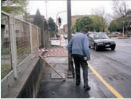
Situazione non regolare, l'occlusione del marciapiede costringe i pedoni ad andare sul ciglio della strada senza protezione
