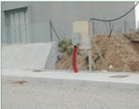
Situazione regolare, gli elementi in tensione sono correttamente protetti
