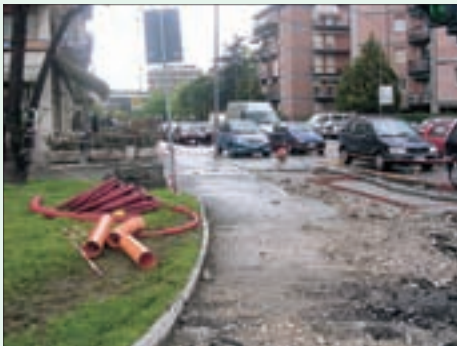
Situazione non regolare, l'area di cantiere prospiciente la strada presenta numerosi sassi
