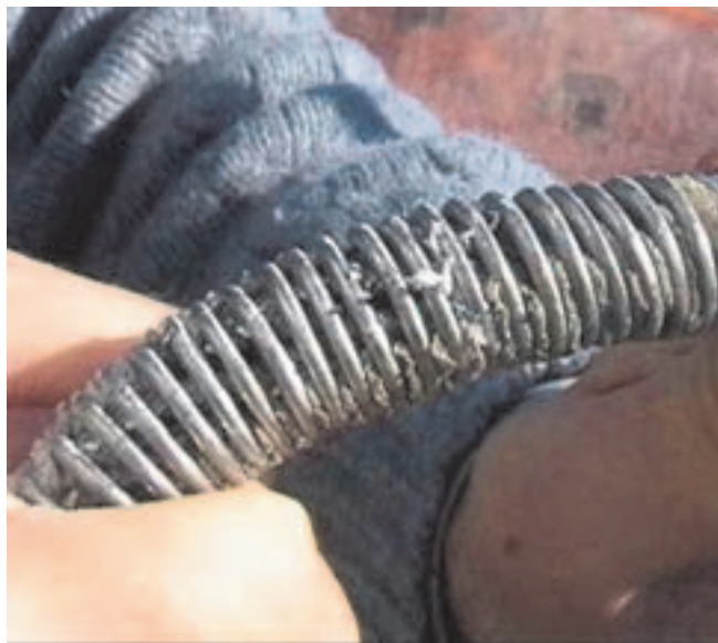
Fig. n. 23: Braca con rivestimento integro ma con fili rotti sotto la protezione.
