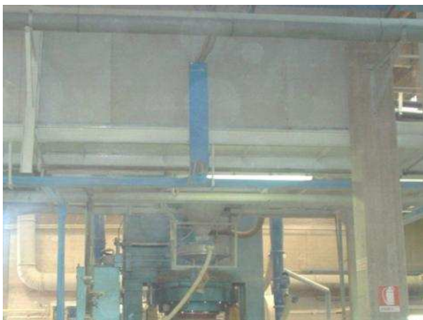
Segregazione laterale della pensilina.
