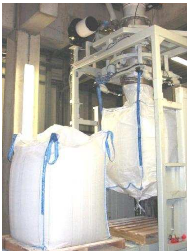
Attrezzature, con aspirazione, per il riempimento dei sacconi: a sx: sistema automatizzato ad alta produttività
