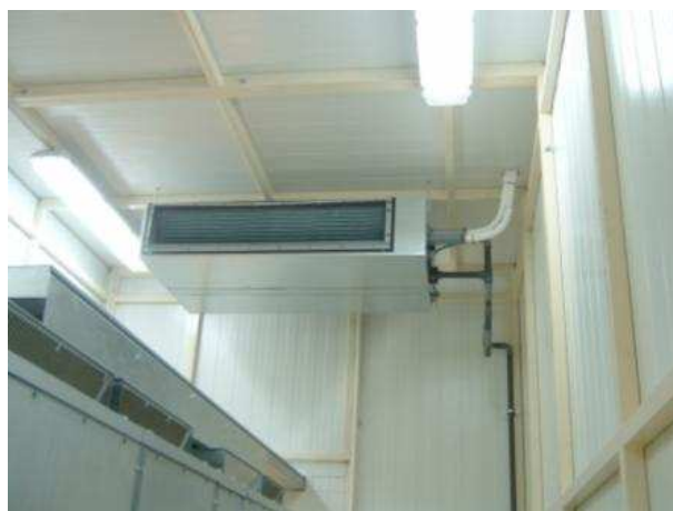
Climatizzare a soffitto nelle sale di protezione degli inverter
