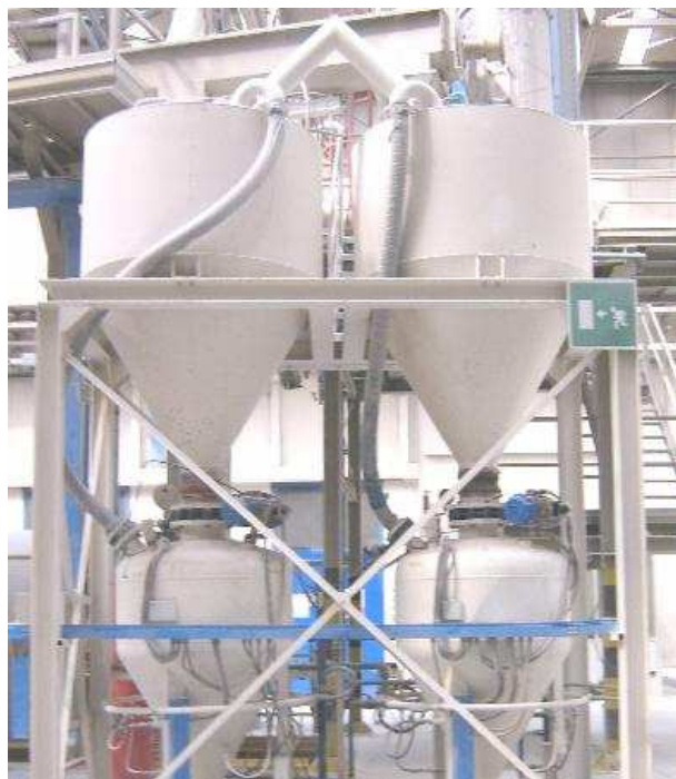
A dx.: Tramogge e propulsori
