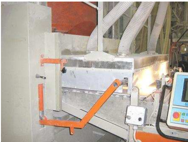
Zona di pressatura (uscita): ampia cappa, fornita adeguatamente di calate per l'aspirazione.
