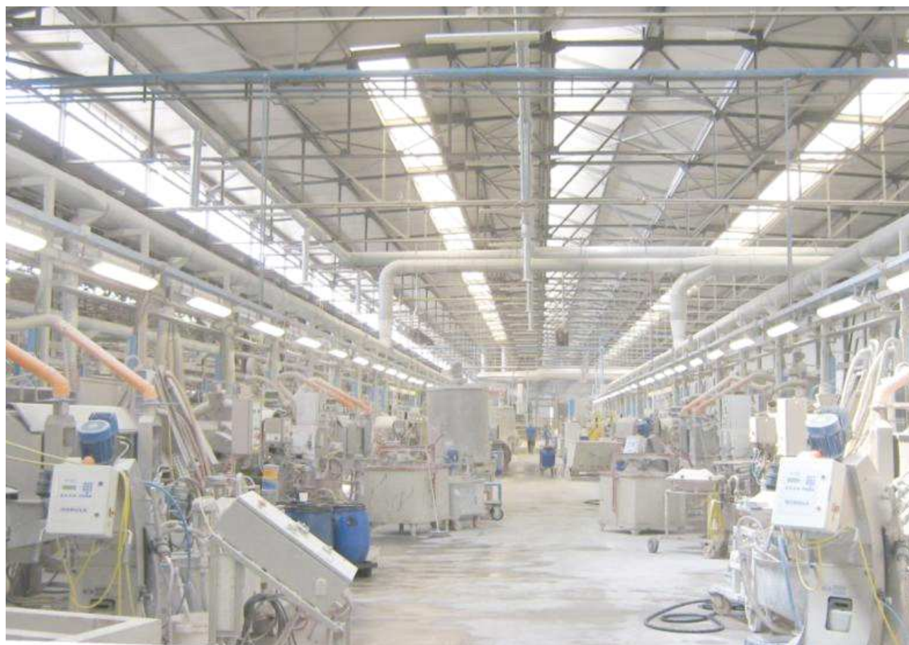
Veduta d'insieme delle attrezzature e del loro collegamento alle tubazioni dell'aspirazione.
