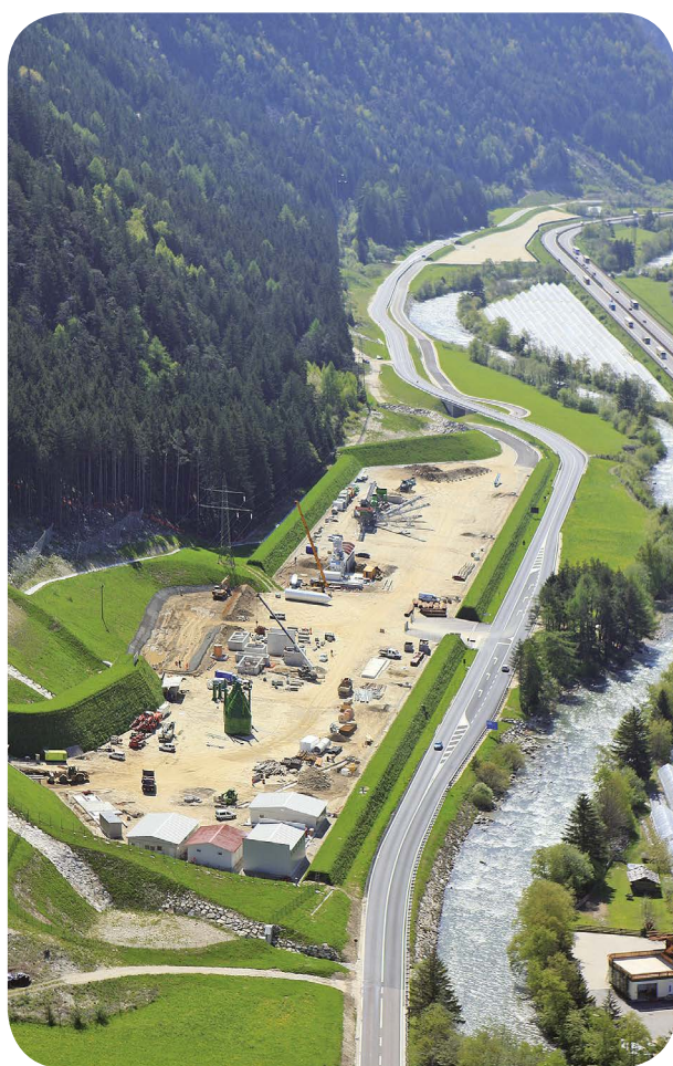
L'area di cantiere di Mules mostra le misure di tutela ambientale e dalle emissioni.
