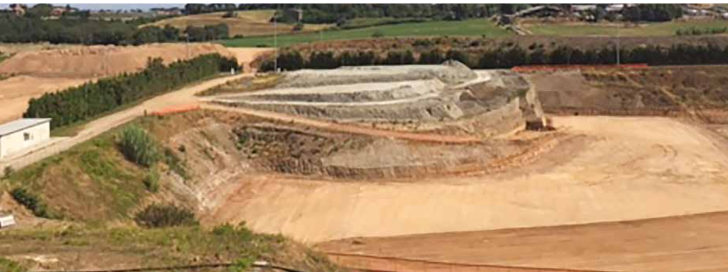
Foto 5.10 Impianto di discarica per rifiuti pericolosi Fonte ISPRA
