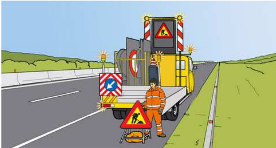
Figura 18 – Chiusura della corsia di emergenza: installazione del cartello di lavori in corso
