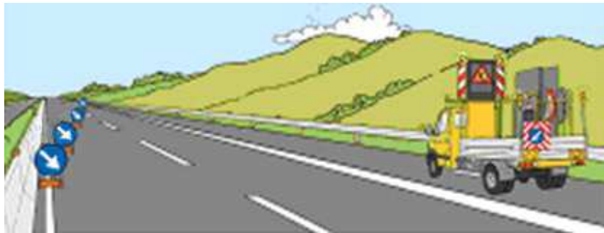
Figura 32 – Chiusura della corsia di sorpasso: installazione della testata di esclusione della corsia
