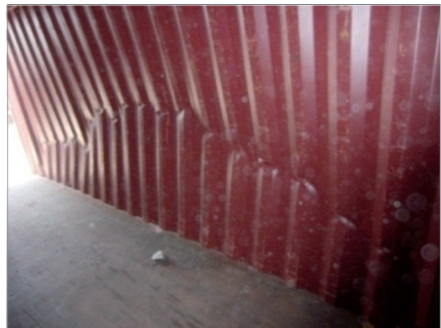
Abbildung 7.50: Beschädigte Seitenwand einer CTU
