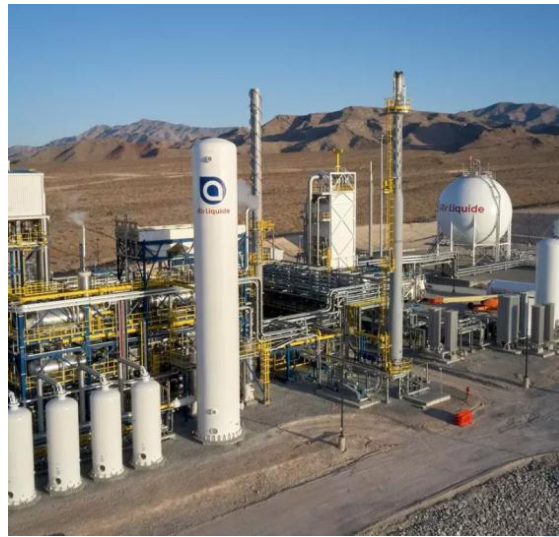
Figura 24 - Impianto da 30 t/d 22
