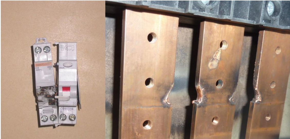
Foto V.2.6 – Danni causati da fulmini alle apparecchiature elettriche
