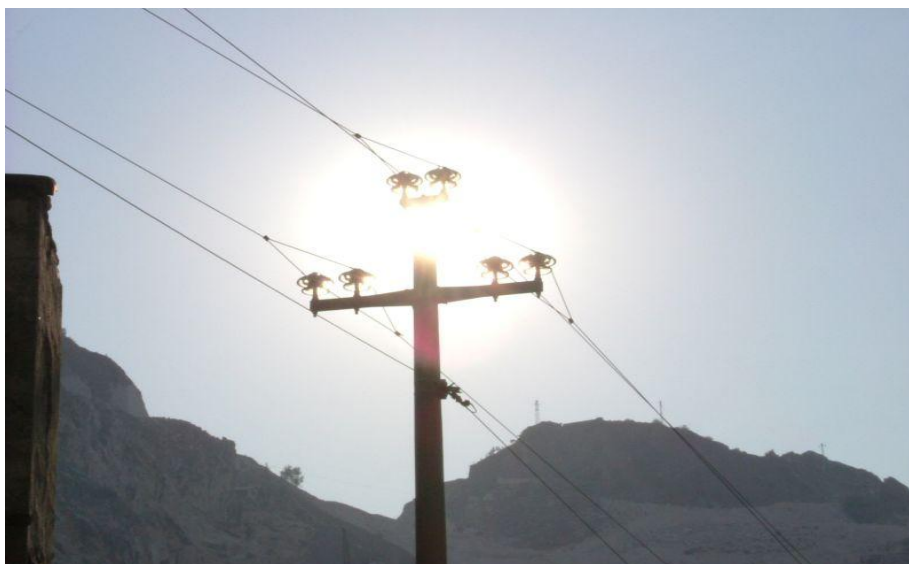
Foto V.2.5 - Linea MT ENEL con IV filo posto al di sotto della terna trifase
