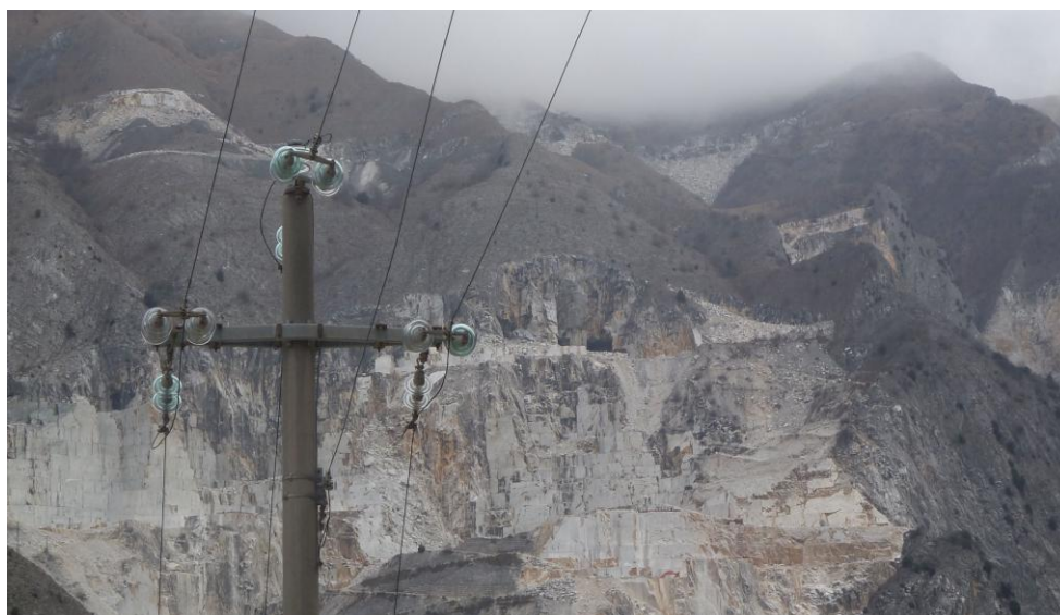
Foto V.2.4 – Linea MT ENEL con IV filo attestato direttamente sul palo
