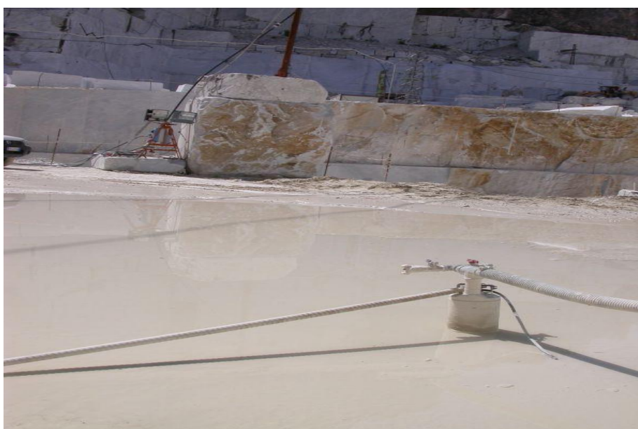
Foto V.2.1 – Pompa a immersione in prossimità del posto di lavoro
