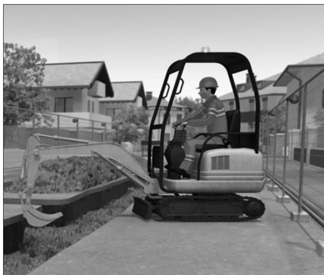
Figura 1 - Caso studio su intervento di manutenzione della rete fognaria svolto in via Berchet, loc. Marghera.
