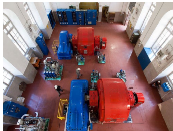
Figura 2 Interno della centrale idroelettrica
