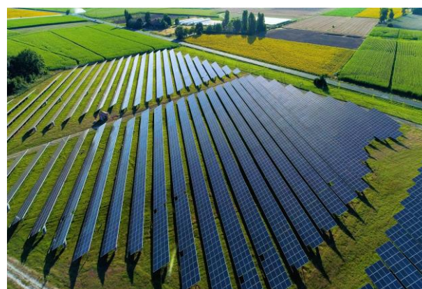
impianto a terra
