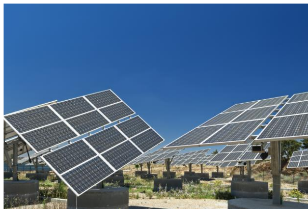
impianto ad inseguimento
