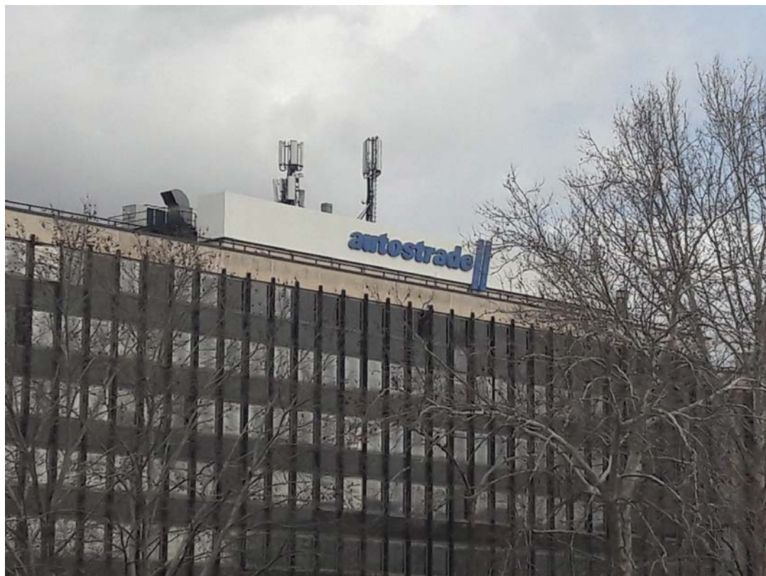
Foto n. 9 "Impianto di telefonia 5G - Via Bergamini, 50"
