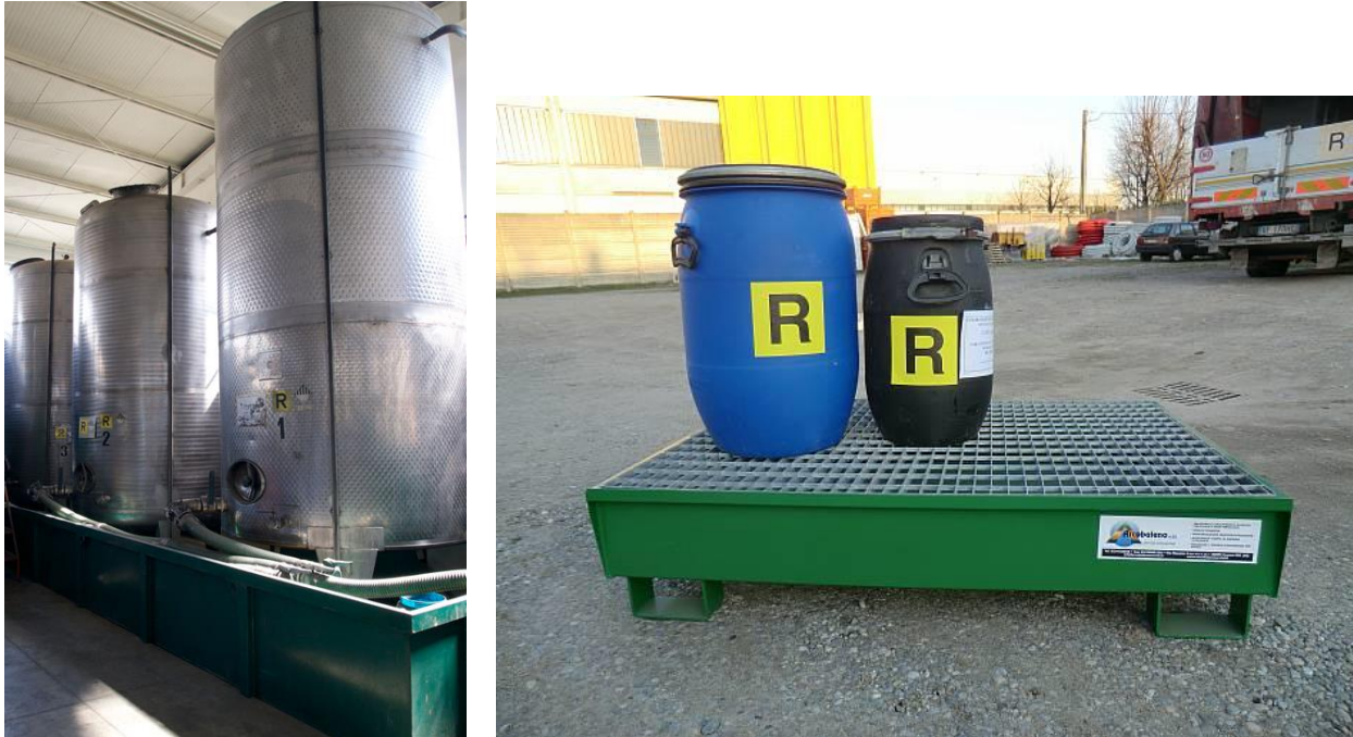
Fig. 10 - Esempi di bacini di contenimento
