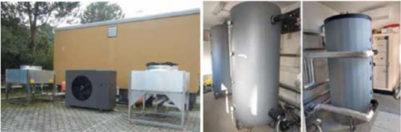
Figura 9-28. Componenti sistema S.A.P.I.EN.T.E.: a sinistra la pompa di calore e il dry cooler, a destra sistema di accumulo termico
