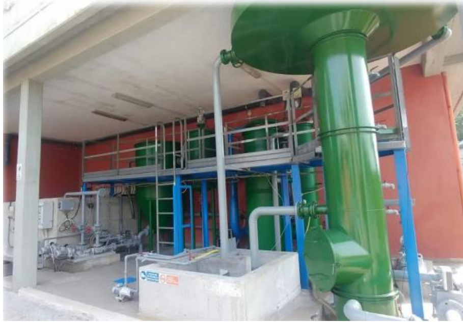
Figura 83. Immagine dell'Impianto FBR-Treviso
