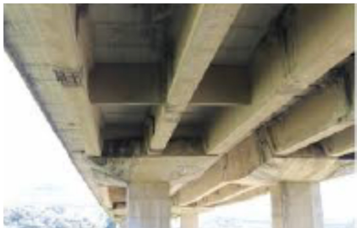
Figura A.1 – Impalcato tipico di Ponte a travata in c.a.p. con sezione aperta e travi parallele
