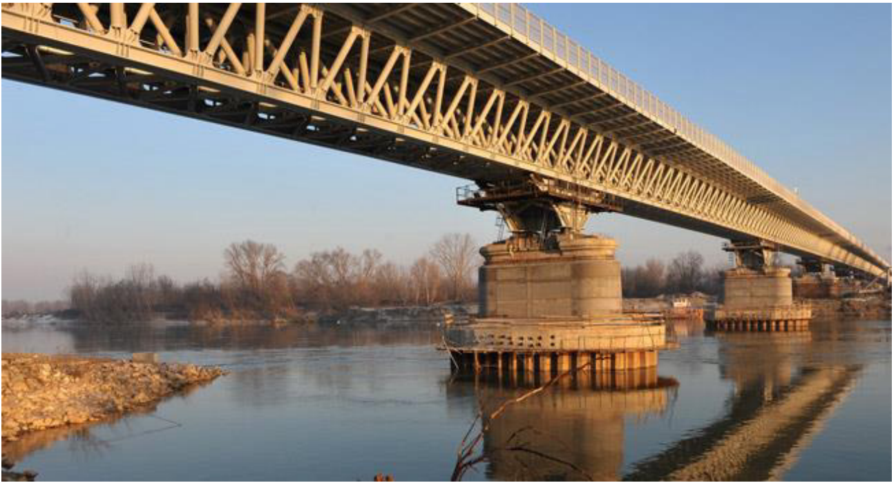
Figura 6.12 - Nuovo ponte sul fiume Po SS9 "Emilia" (Piacenza) di committenza ANAS, zincato a caldo e verniciato
