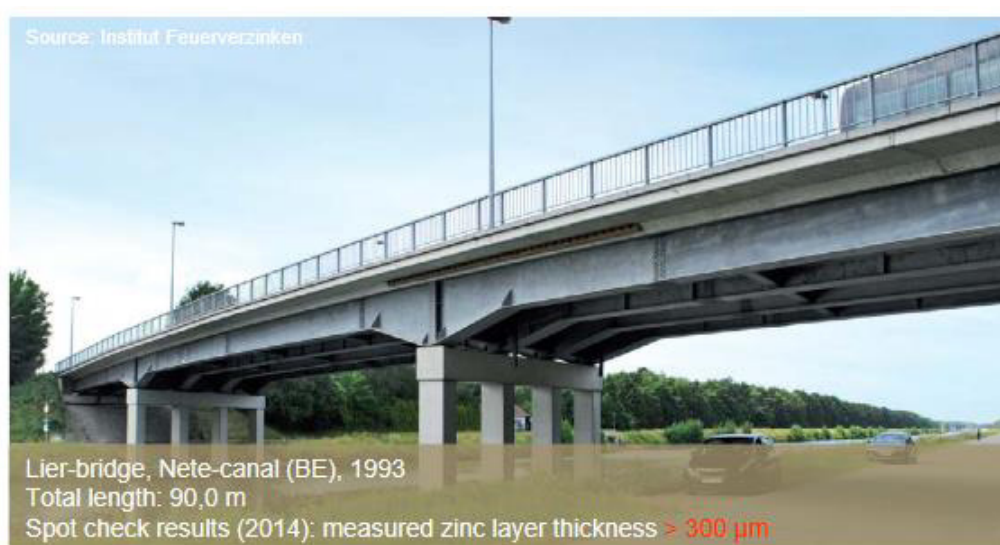
Figura 6.9 – Esempio di ponte in acciaio zincato che dopo più di 20 anni dalla realizzazione presenta uno strato protettivo di spessore > 300 µm
