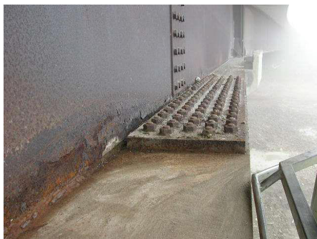
Figura 6.6 - Aree delle travi soggette a stillicidio e ristagno di acque meteoriche
