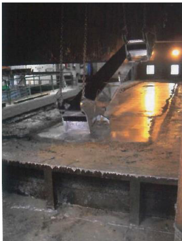
Figura 6.19 - Esempio di esplosione durante l'immersione dell'elemento nel bagno di zinco fuso a causa di un'intercapedine non forata [35]
