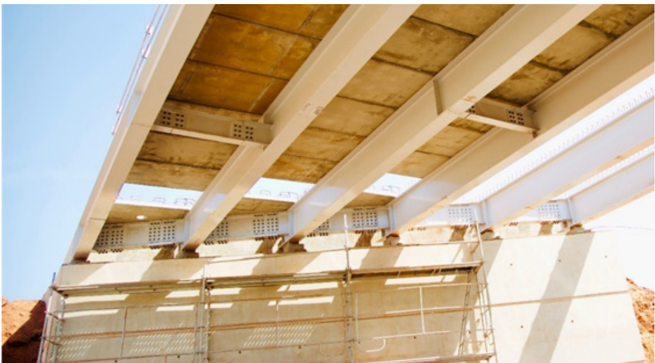
Figura 4.21 – Esempio di appoggio in carpenteria metallica e traversi in appoggio e in campata
