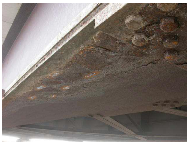
Figura 6.7 - Aree delle travi soggette a ristagno di acque meteoriche
