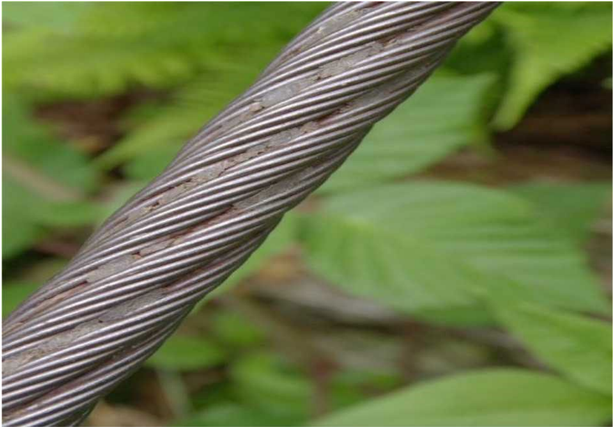
Figura 7 - Fune traente inferiore tra la cabina 3 e il terreno a valle rispetto al punto di caduta del veicolo (fonte Digifema).
