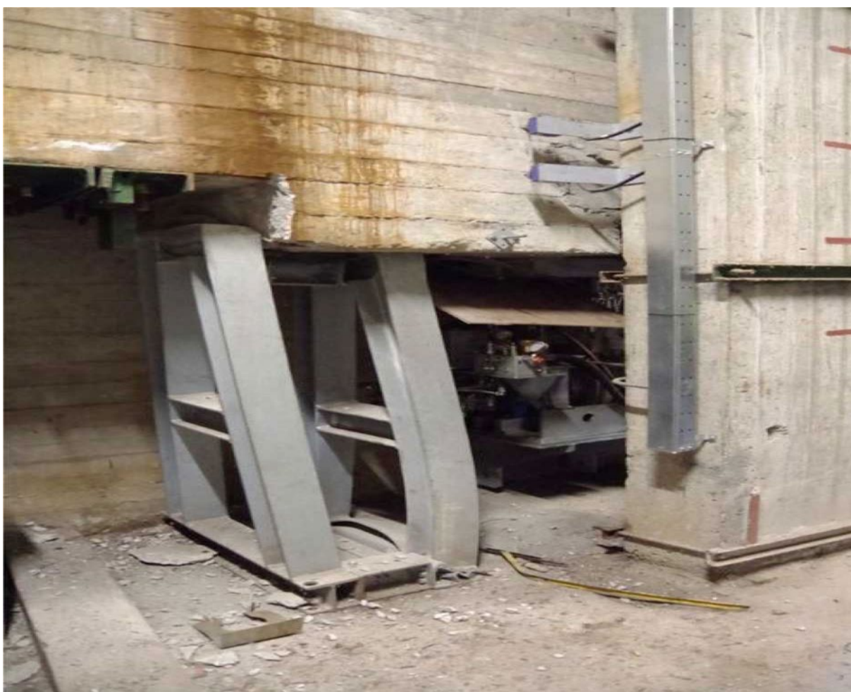
Figura 15 - Contrappeso della fune traente superiore collassato sulla struttura metallica di appoggio (fonte Digifema).
