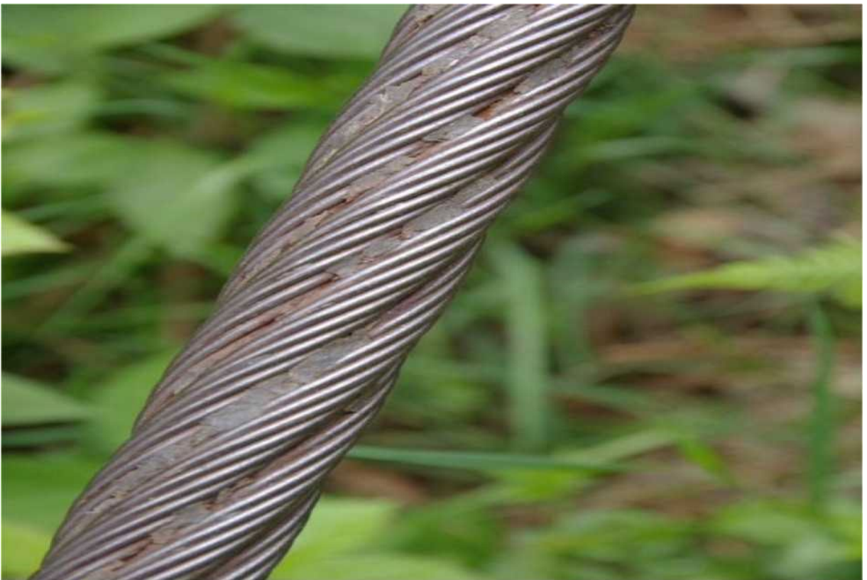
Figura 6 - Fune traente inferiore tra la cabina 3 e il terreno a valle rispetto al punto di caduta del veicolo (fonte Digifema).
