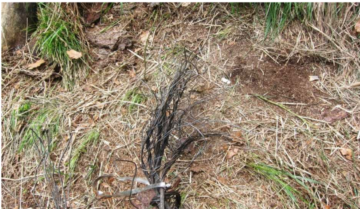
Figura 1 - Fune traente superiore nella zona di rottura; si notano la placchetta metallica per il circuito di sicurezza e i trefoli aperti a pennello (fonte Digifema).
