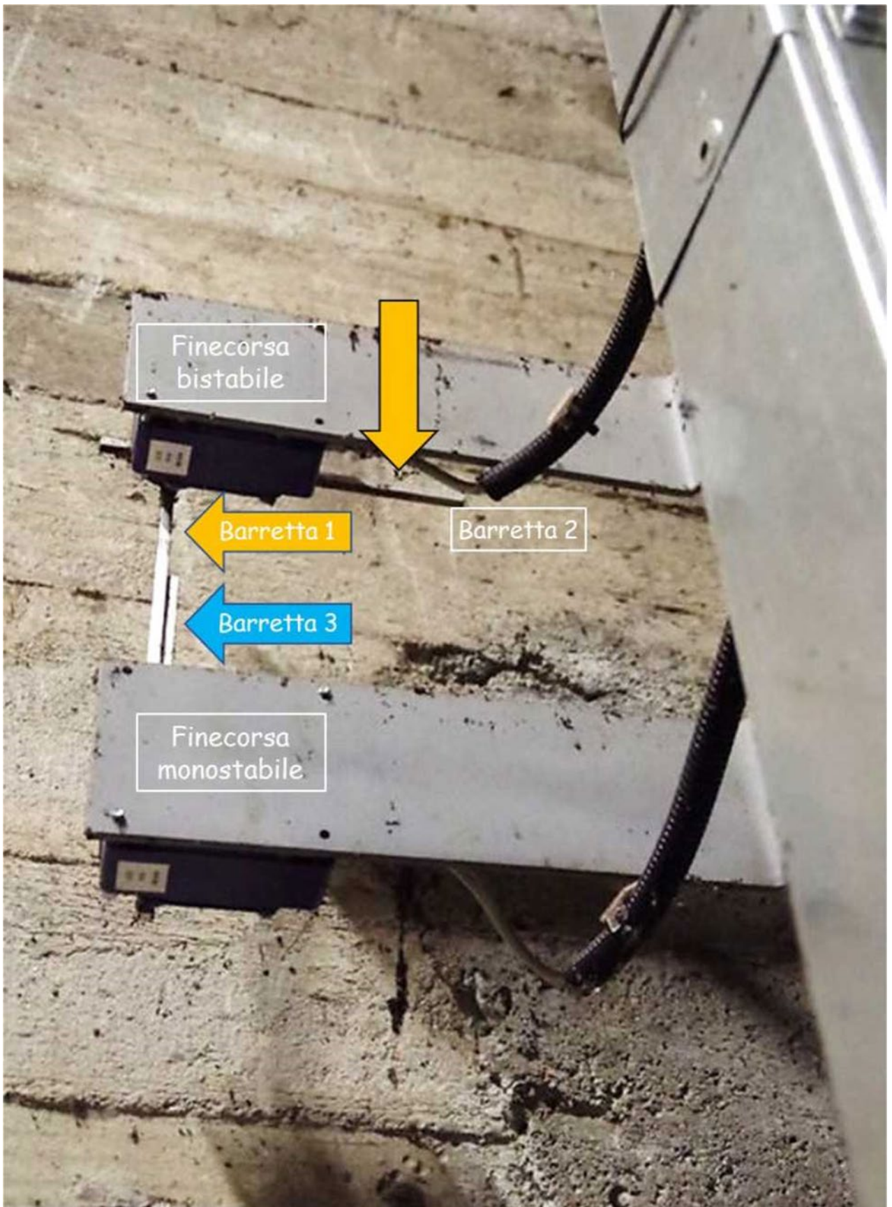
Figura 18 - Particolare del finecorsa bistabile a squadra a 90° per l'allarme (freccia gialla) e del finecorsa di arresto di urgenza (freccia azzurra). Entrambi sono configurati in modo da renderne inefficace il movimento discesa-salita del riscontro metallico posto al fondo del contrappeso (fonte Digifema).
