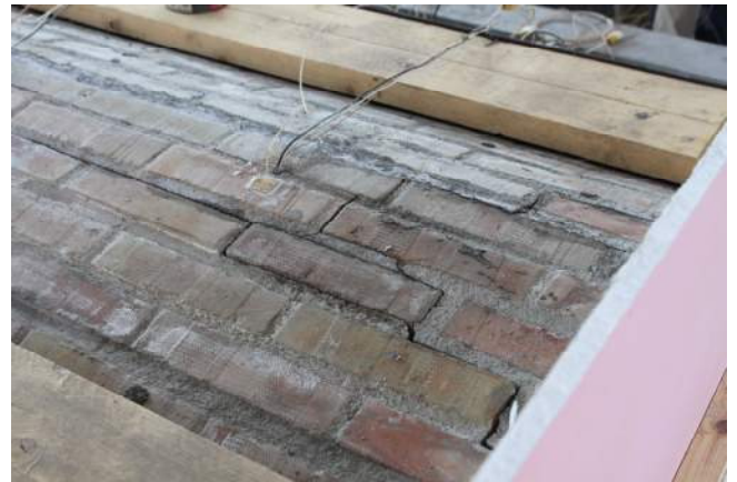
06/07/2015– figura 75 Esecuzione della prova (manifestazione di fessurazioni all'estradosso in corrispondenza della chiave)
