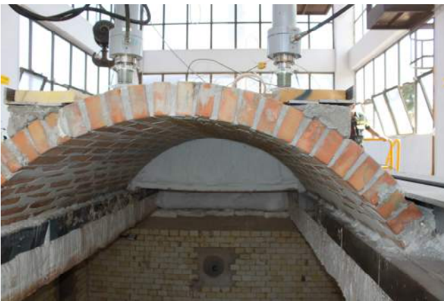
16/6/2015 – figura 56 Tamponatura frontale della volta con lana di roccia e cartongesso (vista interna)
