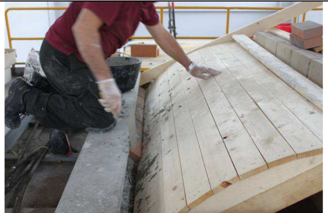
15/5/2015 – figura 31 Inizio della realizzazione della seconda metà volta muraria a partire dalla sezione di imposta alle reni
