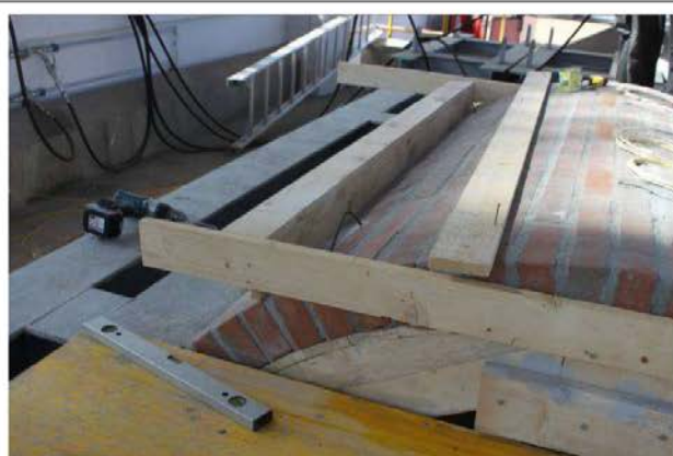
19/5/2015 – figura 39 Predisposizione di spallette in legno per getto cordolo di ripartizione del carico (vista degli spinotti di ancoraggio Ø8)
