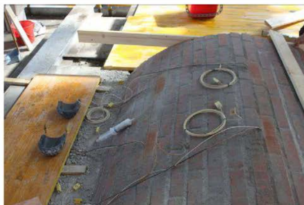
19/5/2015 – figura 37 Vista dei cavi compensati delle termocoppie interne alla volta
