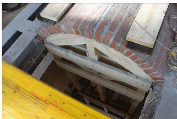
26/5/2015 – figura 46 Vista di assieme dall'alto della bocca forno orizzontale
