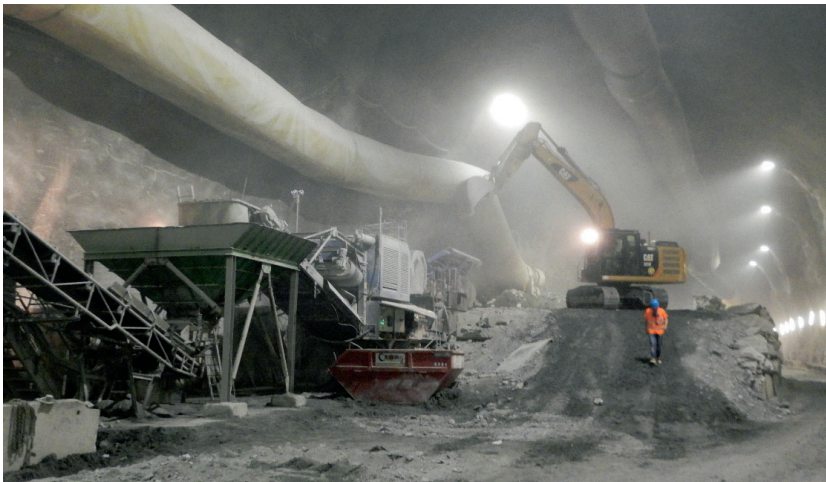
Figura 6.19 - Operazioni di scavo tradizionale in assenza di amianto e gestione dello smarino
