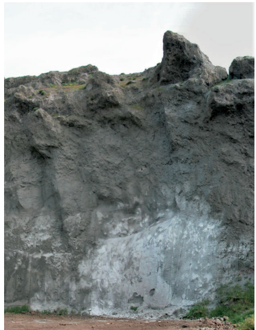
Figura 6.21 - intervento di rivestimento delle pareti del sito estrattivo di Monte Calvario con spritz beton e rete metallica
