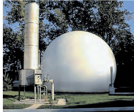
Figura 36: Pallone gasometrico (Fonte: Inail)
