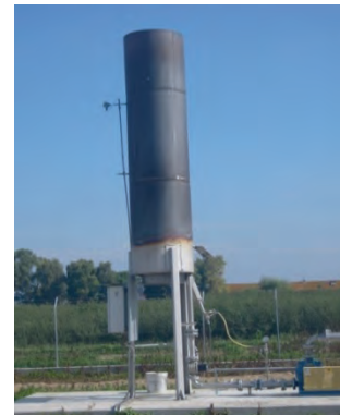
Figura 38: Torcia di emergenza (Fonte: Inail)
