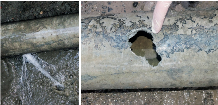
Figure 2 - Tubazione idrica in cemento amianto lesionata.
