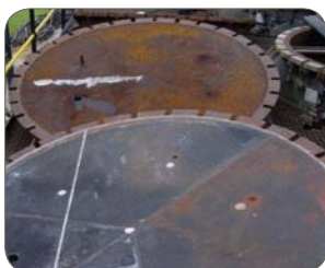
Tipo 1.4003/410, Columbus, Sud Africa. Acciaio al carbonio (in alto) paragonato all'acciaio ferritico (in basso) dopo 6 anni di servizio
