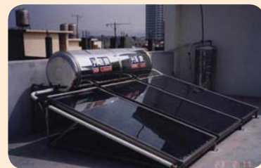
Riscaldatori d'acqua a pannelli solari, Taiwan, Cina.
