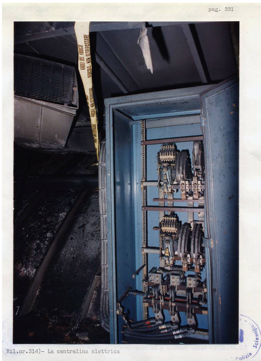
Figura 22. La centralina elettrica del locale elica di manovra.
