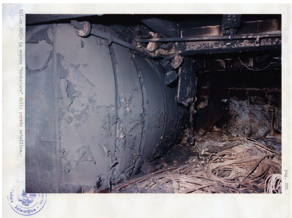
Figura 11. Deflessione della paratia poppiera del locale motore elica di manovra, vista dall'esterno.
