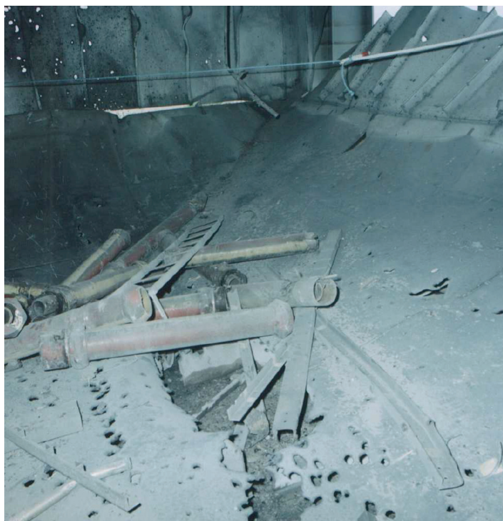
Figura 2. Apertura nel pavimento prodotta da un test di esplosione in una nave.
