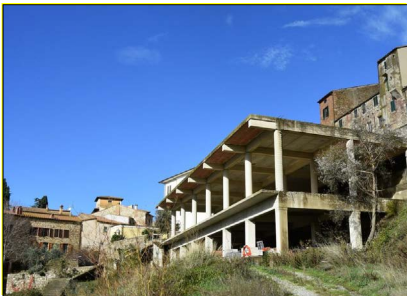
Figura 3.19 Esempio di opere non conformi alle finalità di difesa del suolo: realizzazione di un parcheggio multipiano inserita in un intervento di consolidamento del versante (intervento con procedura di revoca in itinere).
