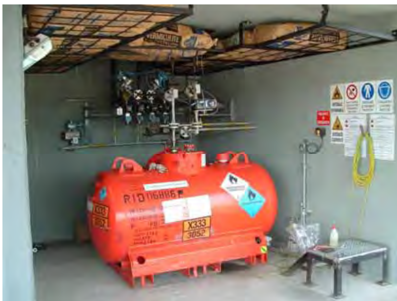
Foto n. 9 – Il box, il contenitore e le relative apparecchiature, dopo la modifica
