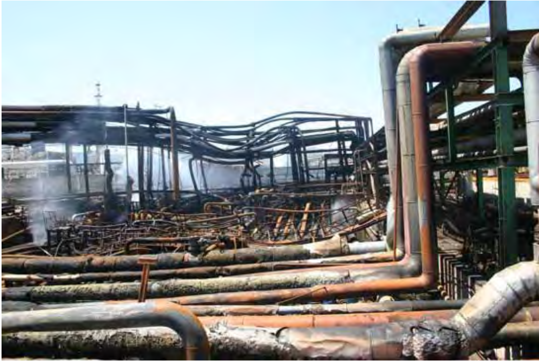
Foto n. 7 : Danneggiamento del fascio tubiero a valle della strada
