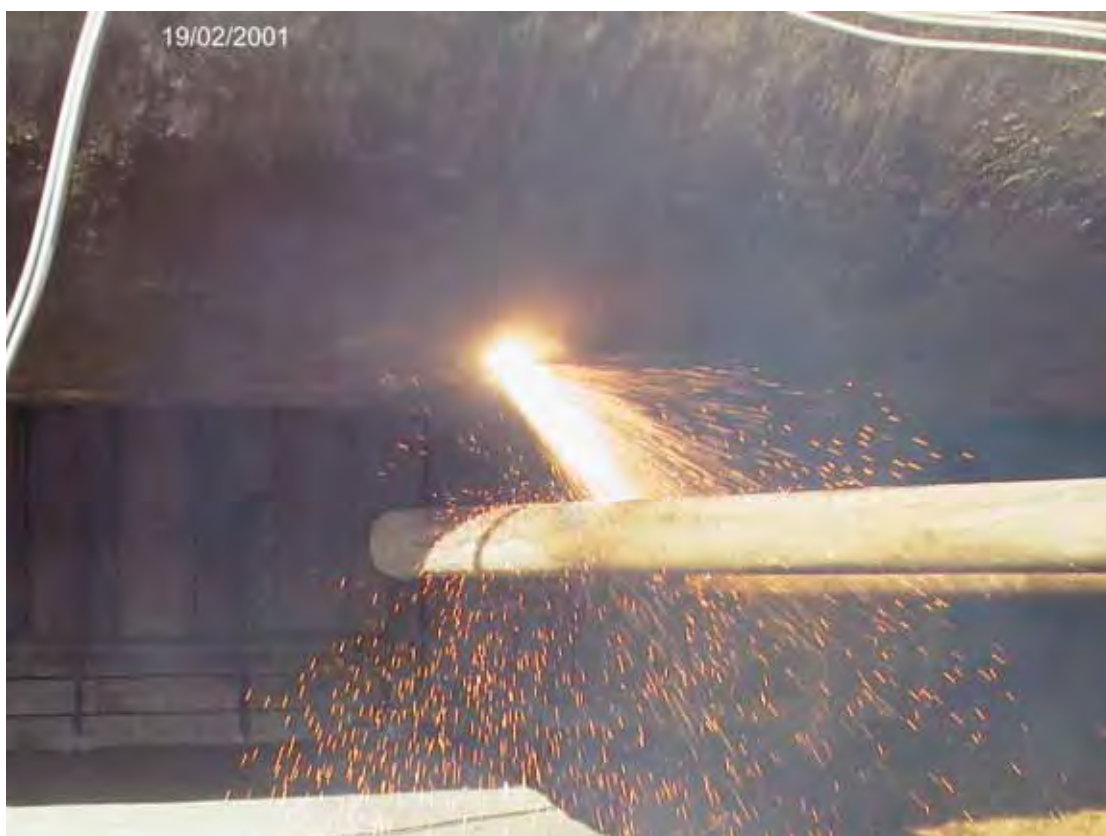
Fotografia n° 5 – Operazione prelievo parte danneggiata
