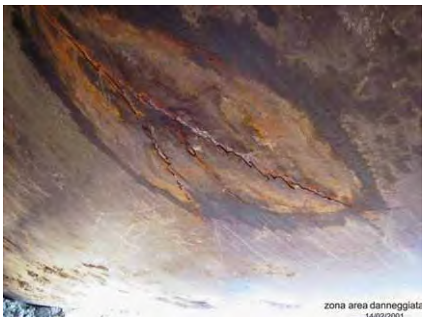
Fotografia n° 4 – Particolare cricca dall'esterno del serbatoio
