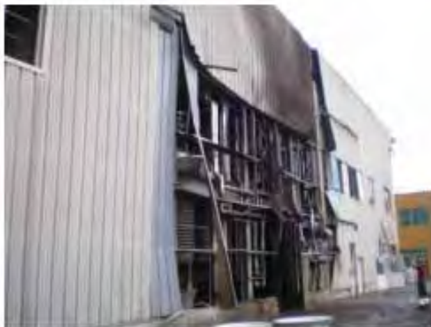
Figura 3. esterno del reparto dopo l'esplosione
