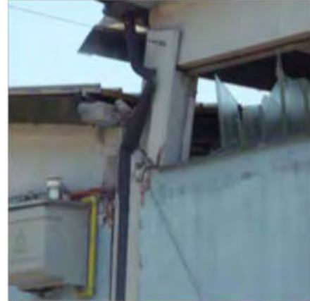
Figura 7 – danni alle colonne
