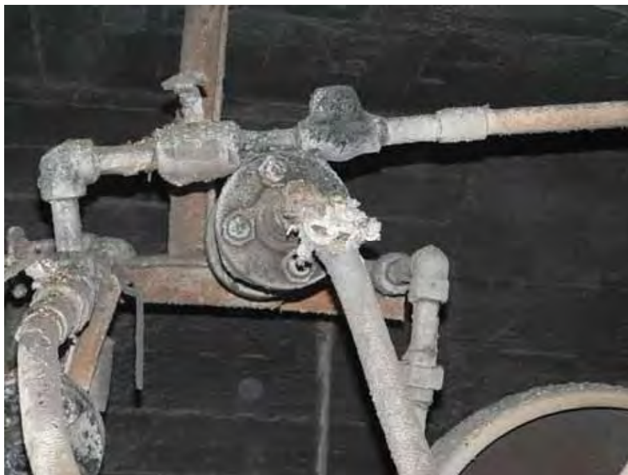
Foto n. 2 – Il piping di collegamento del contenitore; particolare della sezione di rilascio sulla linea metallica flessibile
