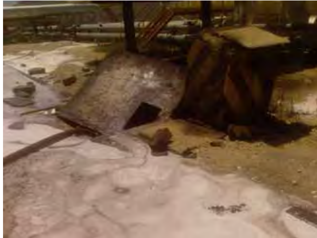
Copertura di uno dei pozzetti sollevata a causa dell'esplosione interna
