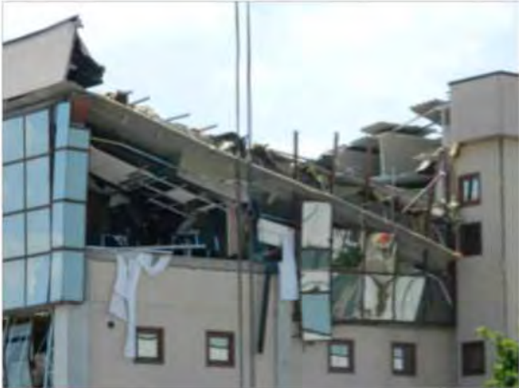
Figura 6 – Scivolamento laterale delle travi della copertura
