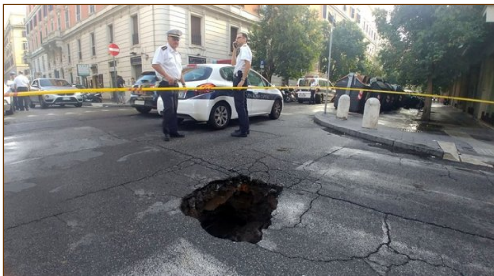
Figura. 2.10.1 – Voragine nel centro di Roma, 26 nov. 2018. Fonte: Il Messaggero
