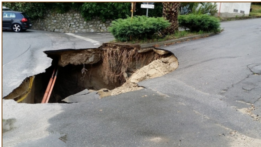
Figura 2.10.2 – Palermo, voragine sulla sede stradale, 1 feb. 2015.
