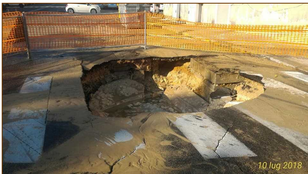
Figura 2.10.4 – Cagliari voragine in strada presso Via Pierluigi da Palestrina - Via Gennaruxi. Fonte: www.youtg.net
