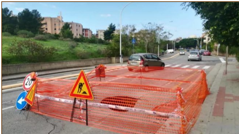
Figura 2.10.5 – Caviari voragine presso Via dei Conversi, 22 ott. 2018.
