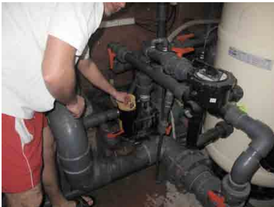
Foto 4: a monte del filtro e della pompa si trova un prefiltra che trattiene le impurità più grossolane.
