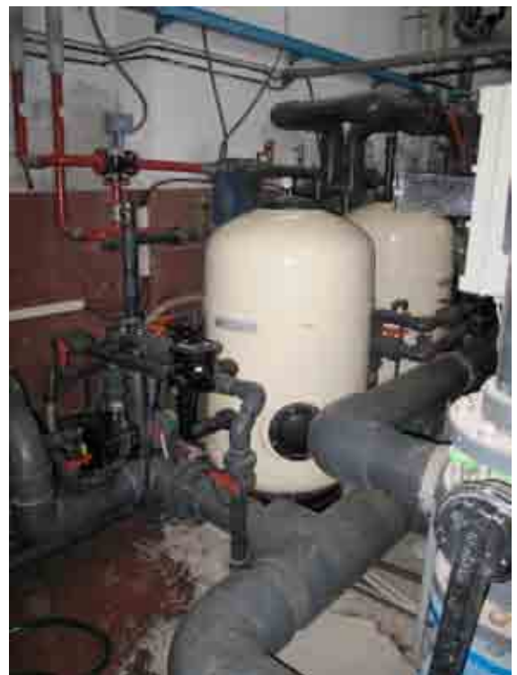
Foto 3: in genere la filtrazione dell'acqua di una piscina avviene in grandi filtri.
