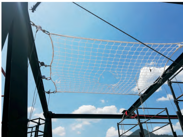
Figura 4.4.5.-10 Rete quadrata 2x2 (m) h = 4 m - Sfondamento della rete
