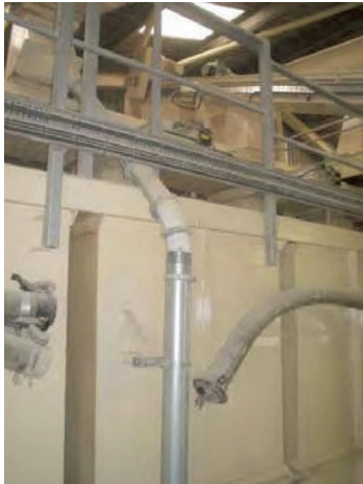
Figura 5.4 - Polvere depositata su tubi rigidi e flessibili (HSE, 2010)
