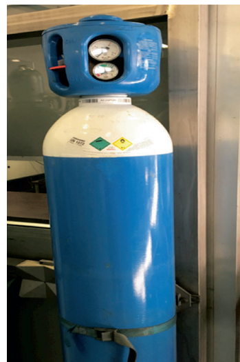
d) Fissaggio di bombola di gas alla parete
