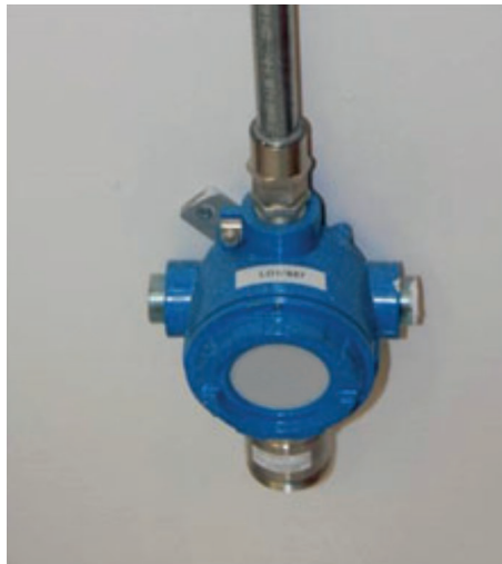
Figura 20: Sensore di livello ossigeno per ambienti dove si usano gas inerti
