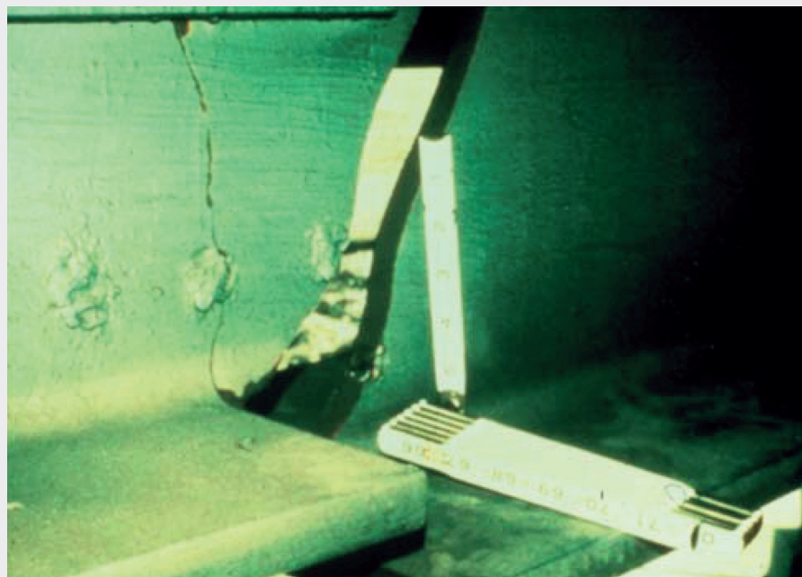
Figura 16. Fessura indotta da difetti di un foro riempito con saldatura [3].
