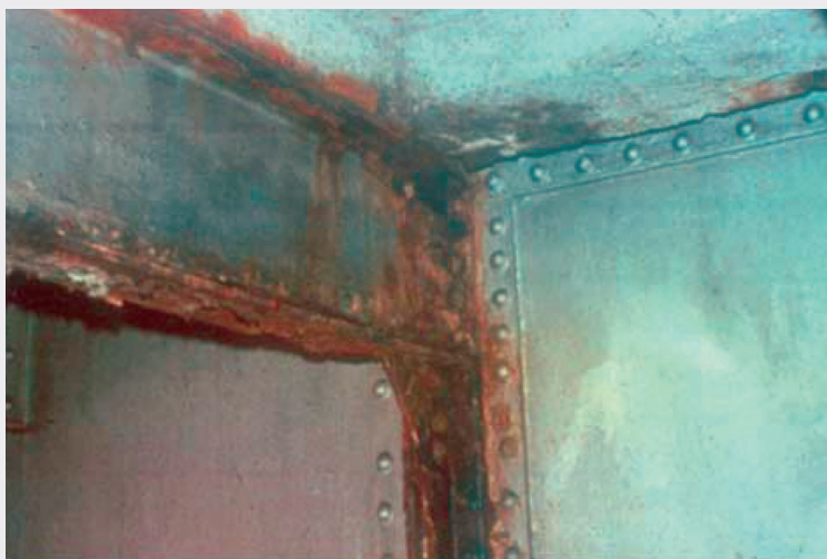
Figura 22. Degrado zona di estremità di un trasverso [3].
