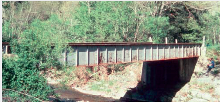
Figura 24. Degrado per corrosione in zone soggette ad elevati sforzi di flessione [3].
