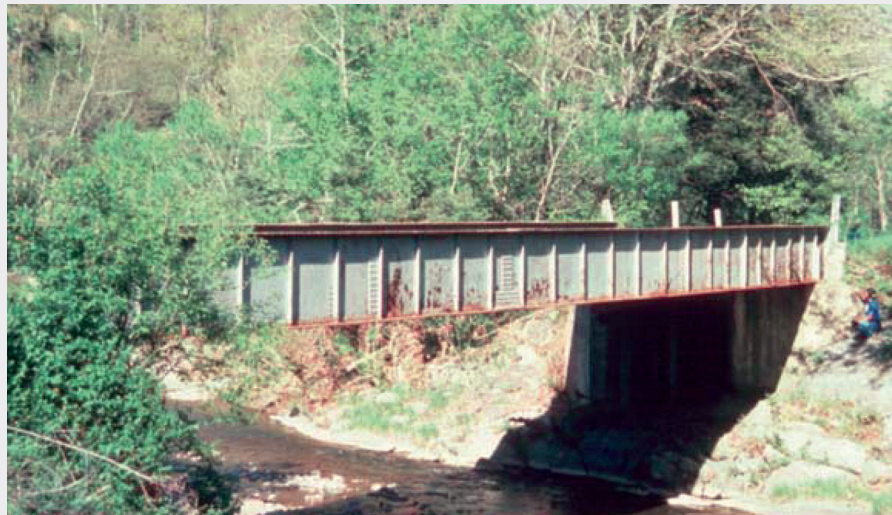
Figura 27. Esempio di danneggiamento per corrosione [3].
