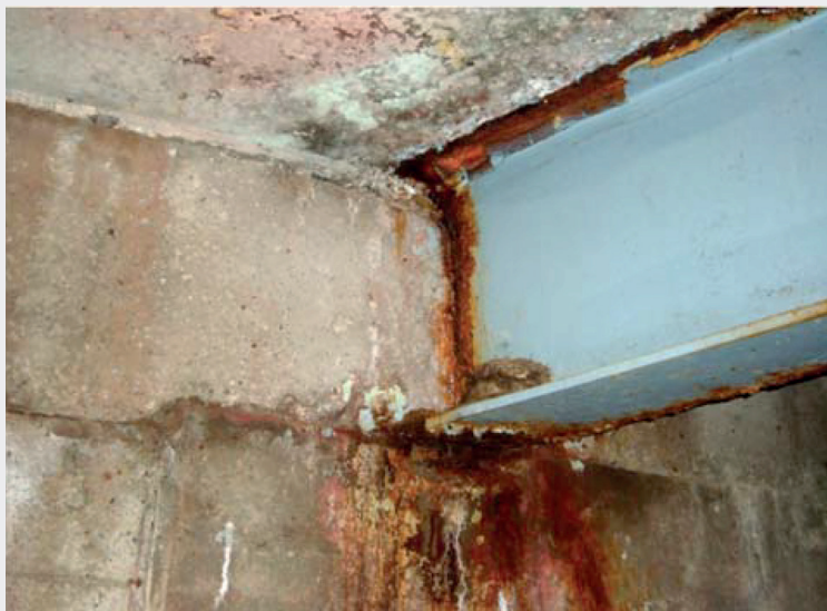
Figura 21. Degrado per corrosione nelle zone in prossimità degli appoggi [3].
