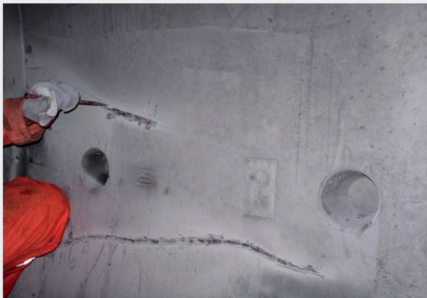
Fig. 6. Apertura della fessura
