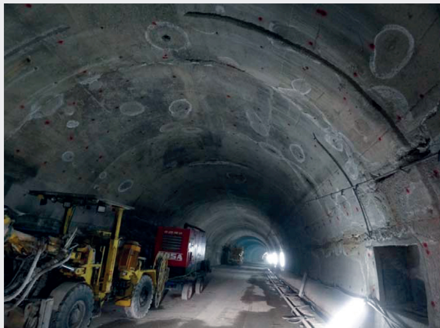
Fig. 5. Danno A1 - Assenza di acqua, fessura di piccola entità
