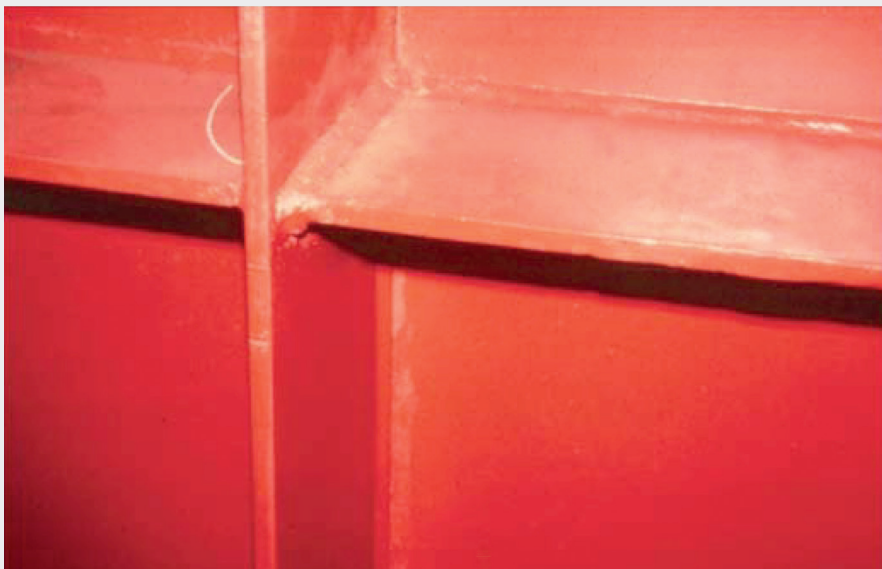
Figura 28. Dettaglio verniciatura elemento metallico [3].
