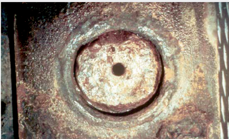
Figura 29. Dettaglio degrado per corrosione di un perno di collegamento [3].
