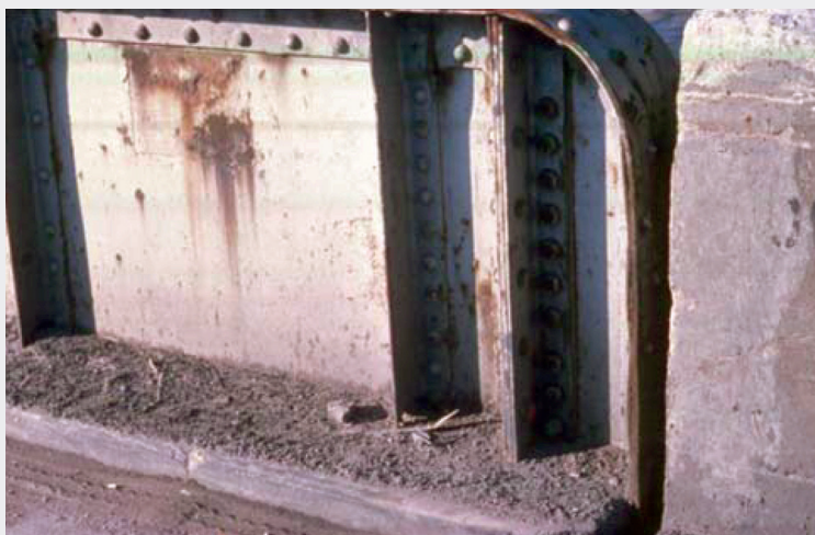
Figura 23. Degrado per corrosione dell'anima della trave di un impalcato a travi estradossate [3].
