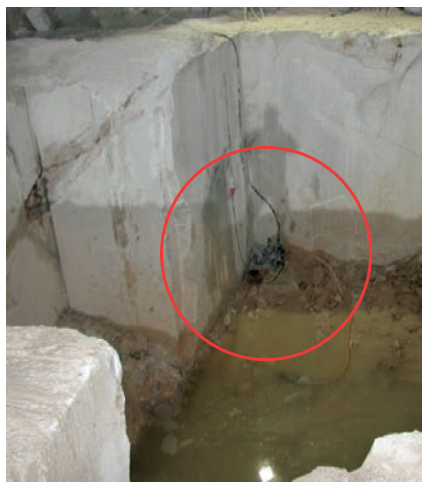
Foto 3 - pompa aspirazione acqua
