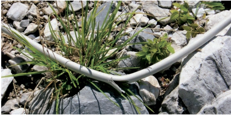
Foto 4 - cavo elettrico che presenta segni di rotture
