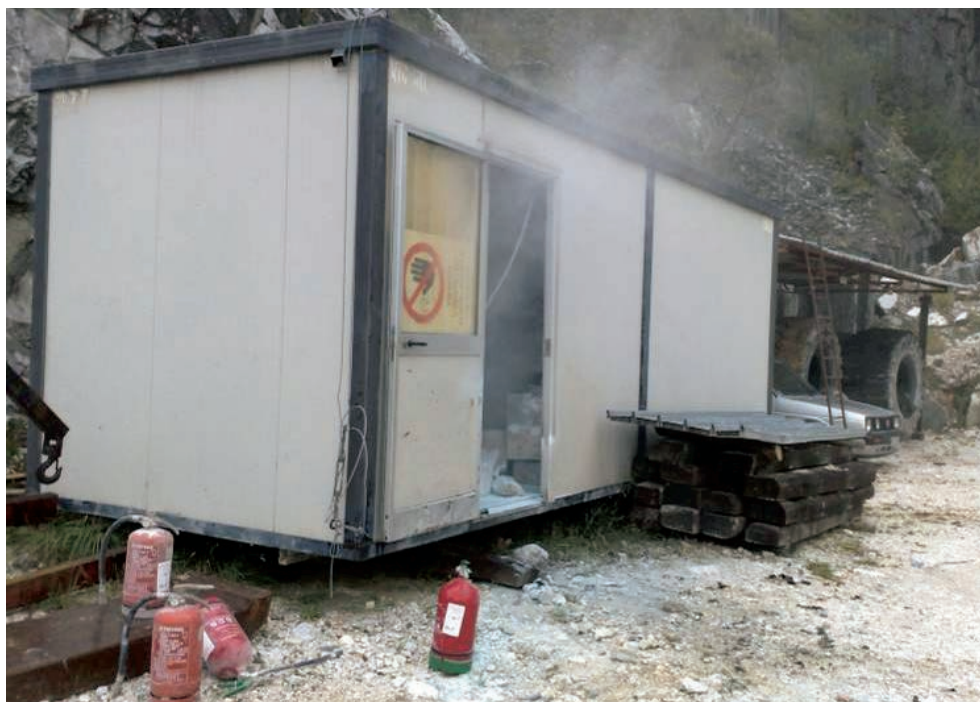
Foto 1 - rappresentativa del luogo di lavoro dopo l'incidento
