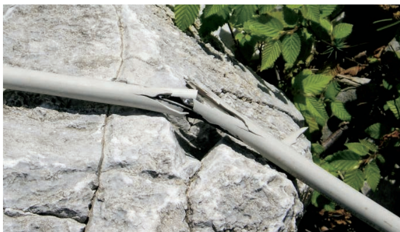
Foto 3 - cavo elettrico che presenta segni di rottura
