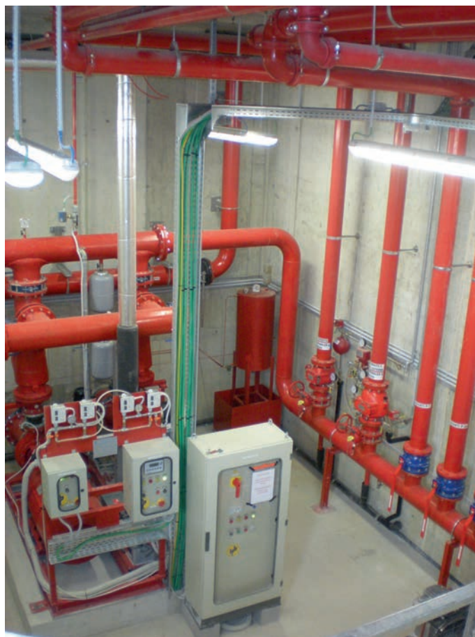
GRUPPO DI POMPAGGIO ANTINCENDIO
