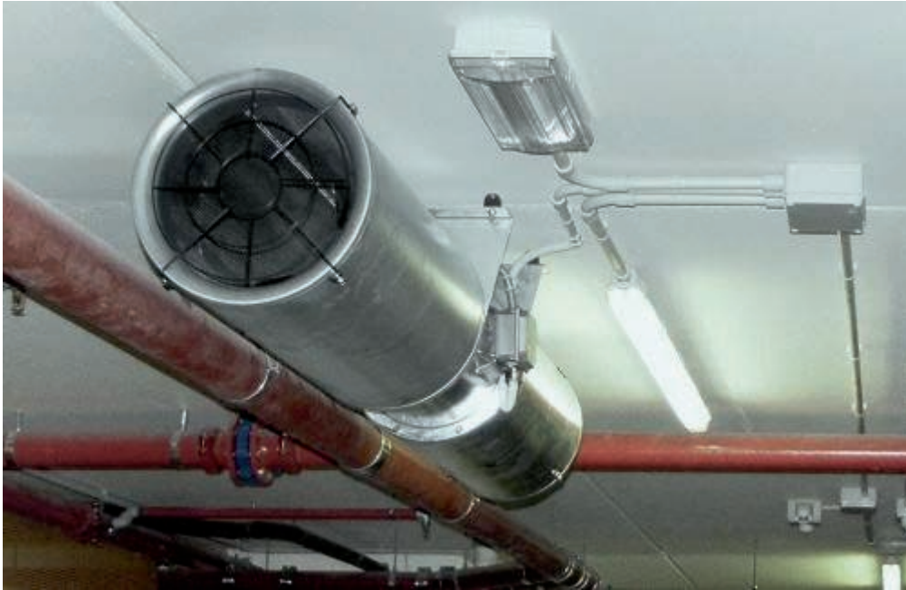
INSTALLAZIONE SISTEMA JET FANS
