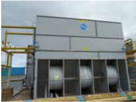
Figura 2. Torre di condensazione
