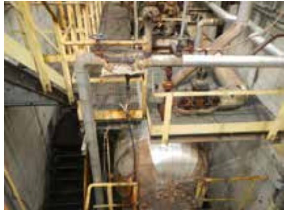
Fossa contenente pompe di sollevamento
