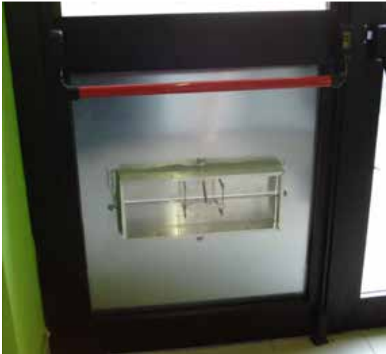
Figura 8. Particolare di serranda di sovrappressione installata su una porta di esodo
