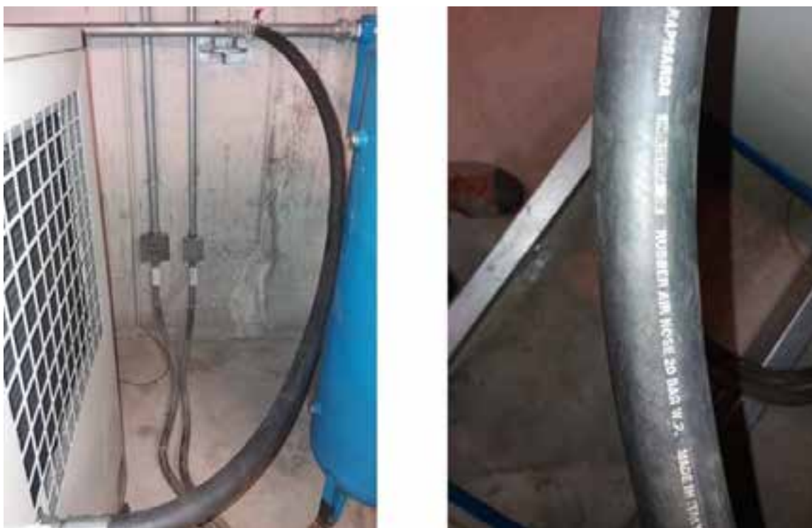
Foto 3. Tubazione di collegamento del sottoinsieme alla rete aria compressa
