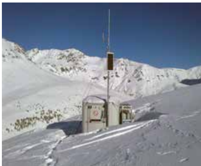
Figura 1. Unità centrale dei gas con stazione meteorologica integrata
