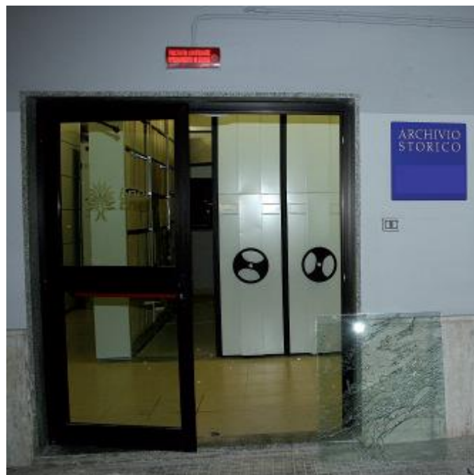
Figura 6. Il caso studio. Gli effetti dell'esplosione coinvolgente gas inerte.
