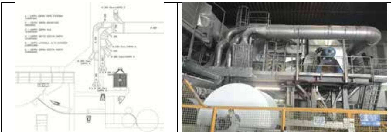
Figura 2. Impianto di aspirazione macchina continua
