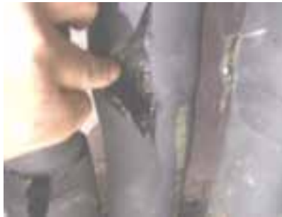
Figura 3. Corrosione esterna della tubazione sotto la coibentazione in neoprene
