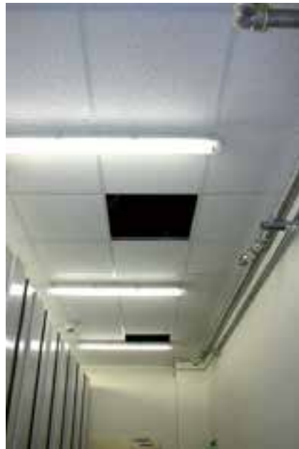
Figura 5. Particolare degli ugelli di scarica del gas estinguente
