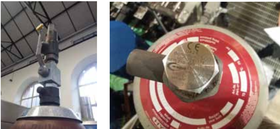
Figura 9. Differenti dispositivi di sicurezza: Valvola di sicurezza (tarata a 210 bar) e Disco di rottura (tarato a 210 bar)
