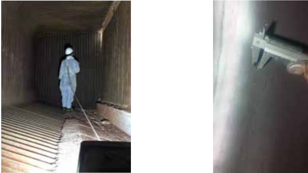
Figura 2. Operatore durante l'esame visivo del generatore RUTH e misura di un difetto superficiale riscontrato.
