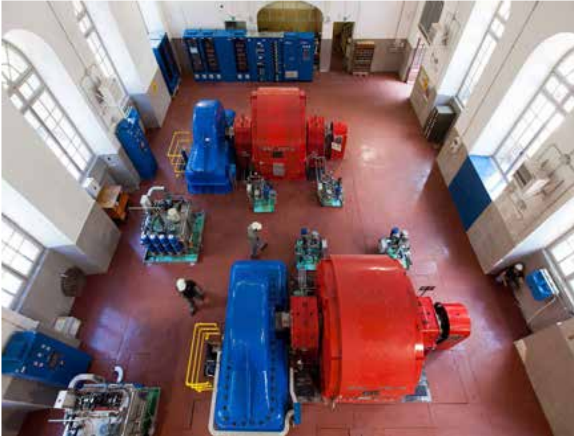
Figura 10. Vista d'insieme della centrale di Gressoney con attrezzatura a pressione
