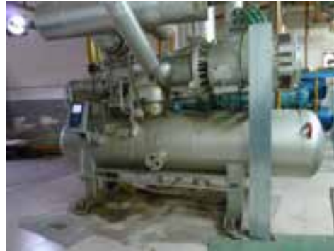
Figura 3. Compressore per ammoniaca
