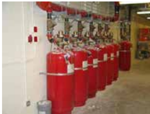
Figura 12. Sistemi automatici antincendio
