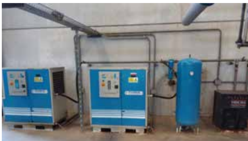
Foto 2. Sotto insieme stazione aria compressa
