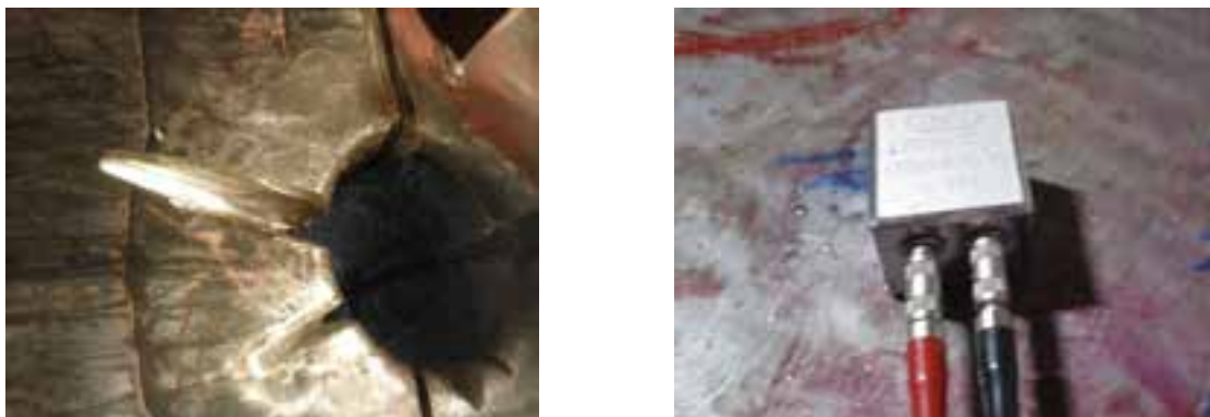
Figura 11.3 Bocchello 12C - Particolare della zona di riparazione delle cricche dopo lo scavo con mola per la loro eliminazione; in genere la parte più profonda si localizzava nella zona del raccordo e area adiacente.
