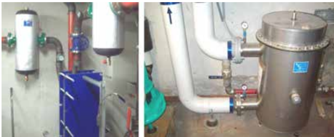
Figura 6. A sin.: scambiatore e degasatori circuito caldaie e impianto; a dx.: filtro impianto dotato di controlavaggio e manometri di controllo
