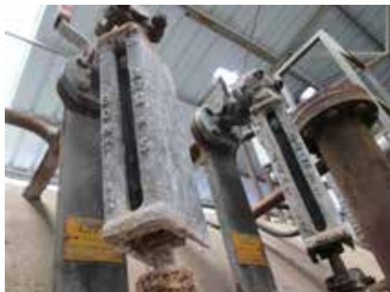
Figura 6. Dettaglio Indicatori di livello sottoposti a corrosione
