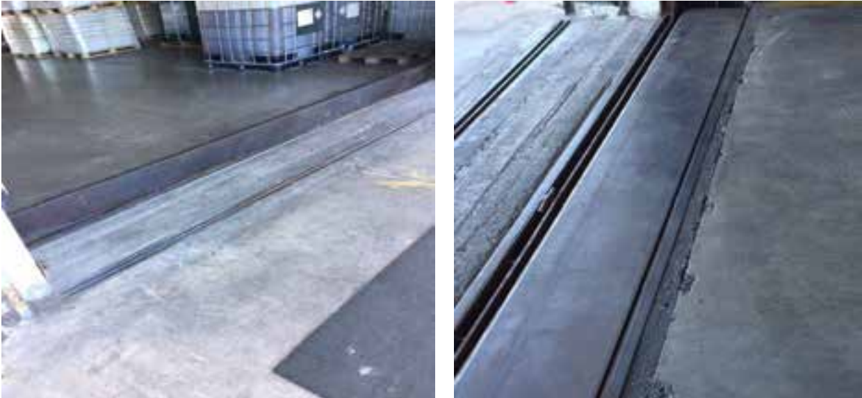
Figura 5. Azienda 1 - Contenimento di versamenti e schiuma - paratie a scomparsa
