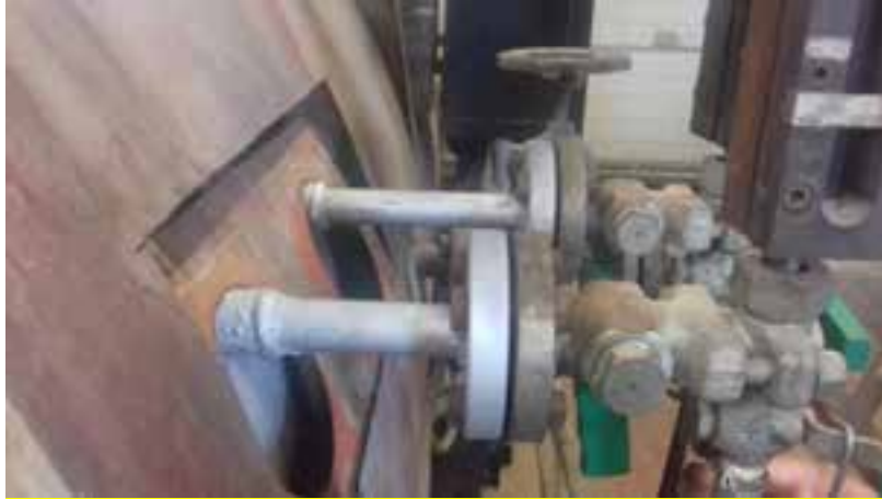
Figura 9. La sostituzione delle connessioni del gruppo indicatori di livello risulta essere un intervento di riparazione statisticamente rilevante
