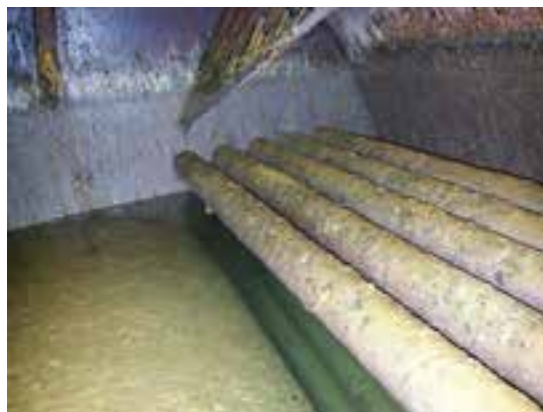
Figura 10. Tubi superiori al focolare fortemente incrostati
