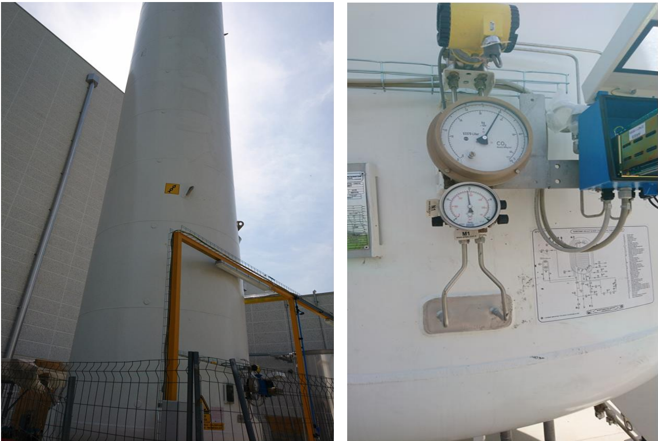
Figura 2. Esempi di installazione di serbatoi criogenici e strumentazione
