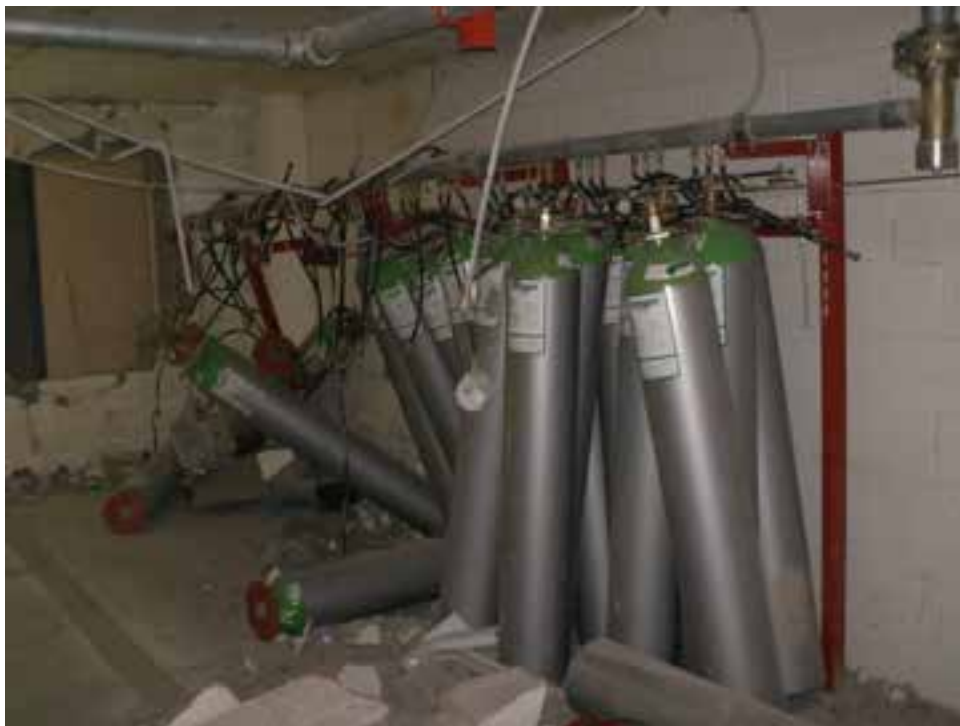
Figura 1. Effetti di una esplosione coinvolgente gas inerte
