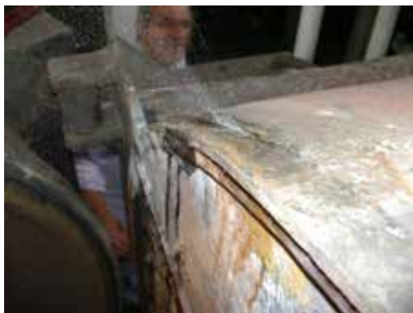
Figura 8. Cricca su giunzione saldata piastra tubiera-fasciame corpo cilindrico riscontrata con prova idraulica
