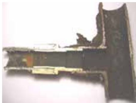
Figura 2. Sezione derivazione tee: visibili corrosione esterna (per perdite dalla filettatura) ed interna
