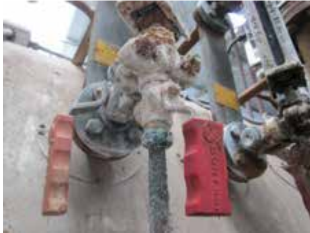
Figura 7. Dettaglio Indicatori di livello sottoposti a corrosione
