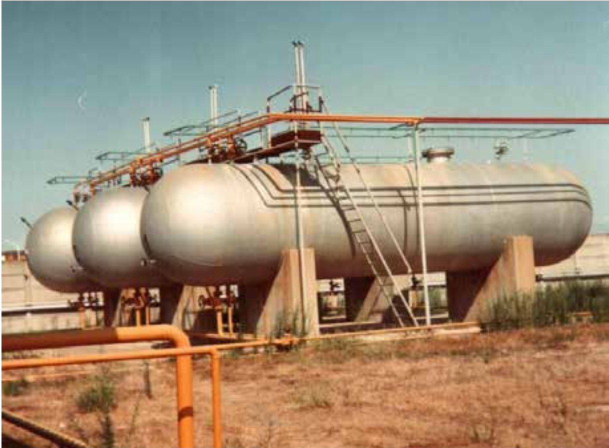
Figura 2. Esempio di installazione di serbatoi
