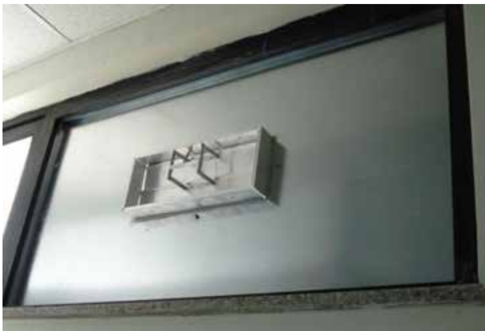
Figura 9. Particolare di serranda di sovrappressione installata su una finestra
