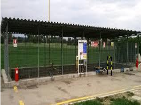
Serbatoio per GPL interrato in stazione di servizio carburanti
