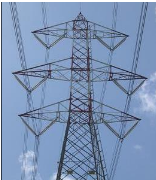
Figura 4: Esempio di due linee a 380 kV installate in doppia terna.
